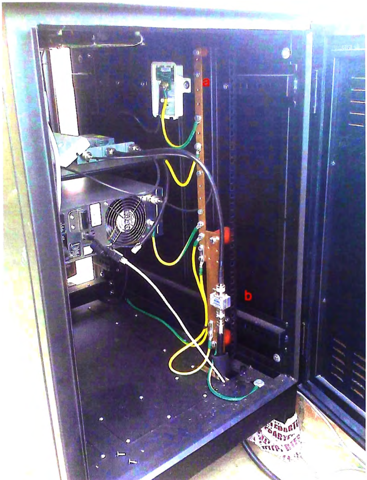
Figura E.3 Interconexión de equipos. a) regleta de conexiones puesta a tierra. B) Cable coaxial entre duplexor y antena
