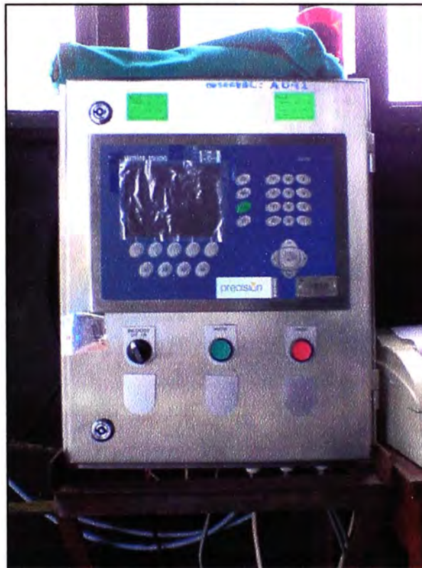
Figura 3.6 Vista del tablero de control de proceso.
