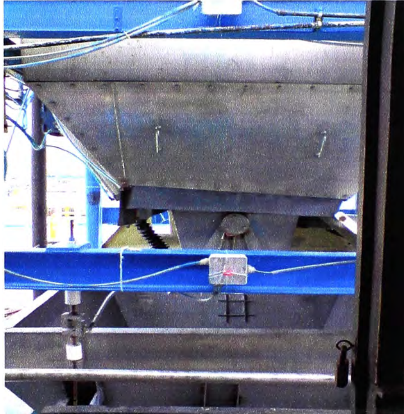
Figura 3.3 Vista de la pre-tolva y la tolva.
