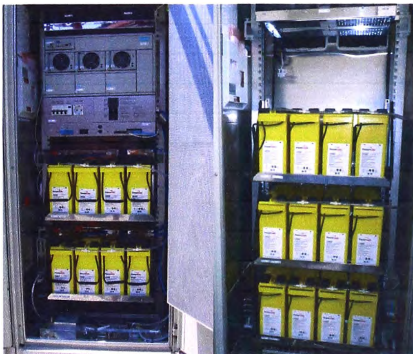
Figura 29. Sistema eléctrico (Tablero general, bancos de batería)
