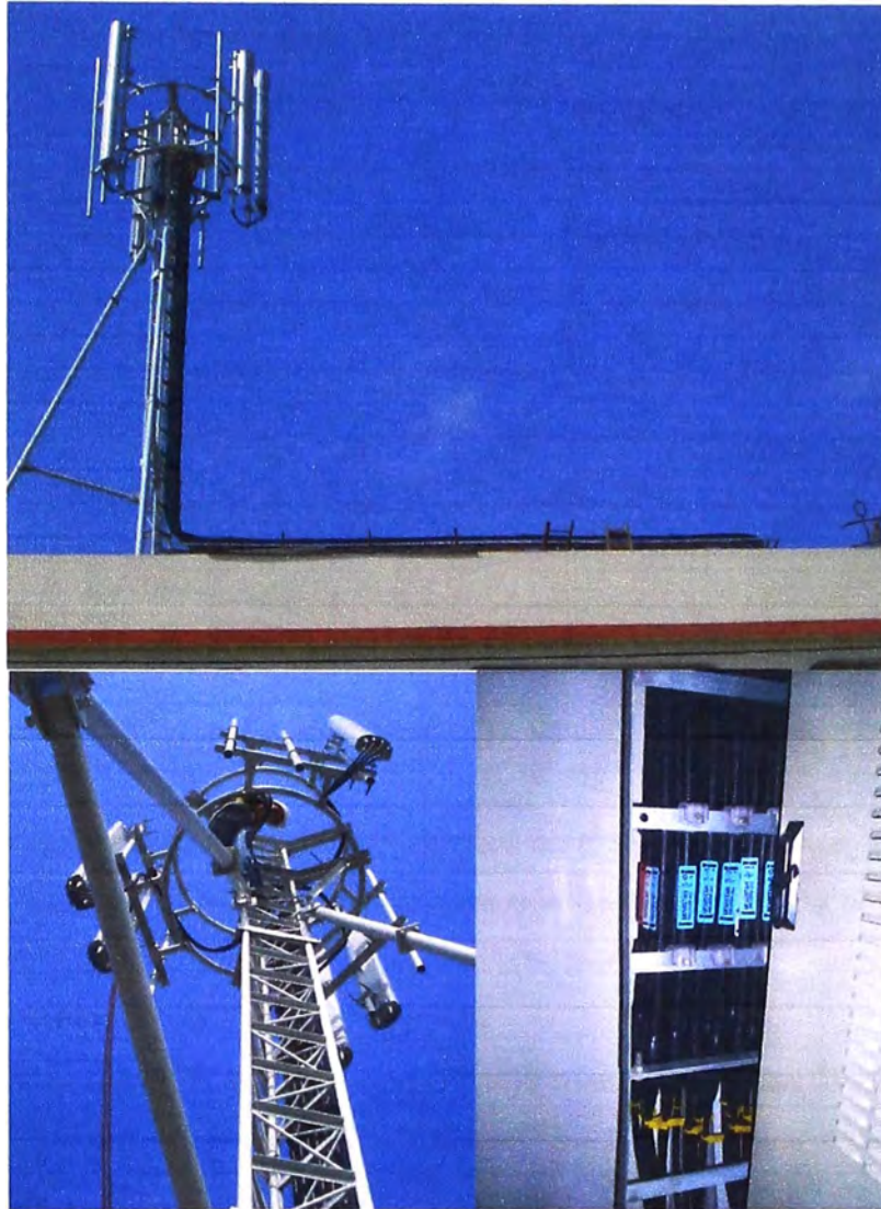
Figura 27. Sistema Radiante (Feeder, antenas)
