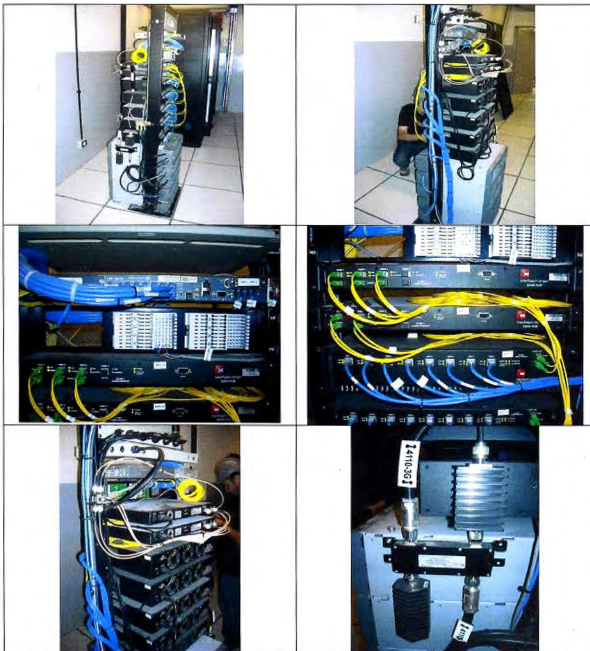
Figura 4.1 Reporte fotográfico de instalación en sala de equipos. (Ref. [5])
