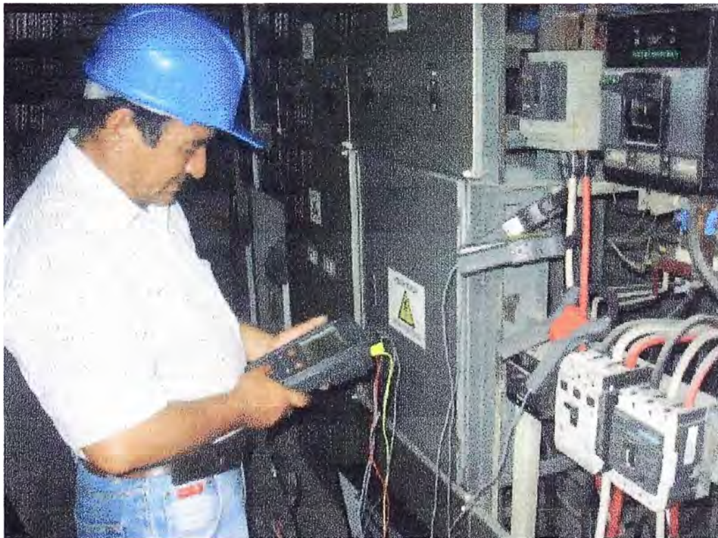
ANEXO H: ANALIZADOR DE REDES ELECTRICAS EN PROCESO DE MEDICION
