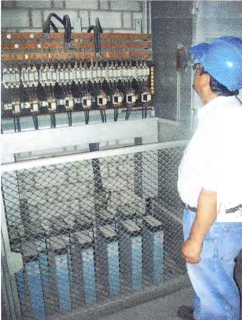
ANEXO I: BANCO DE CONDENSADORES DE LA PLANTA INDUSTRIAL
