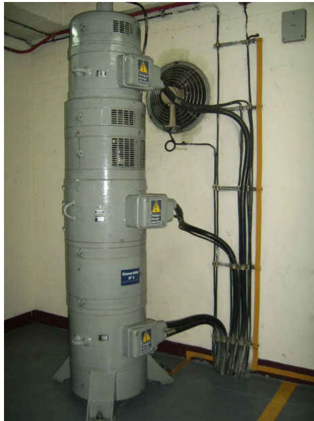
Conjunto motor síncrono y alternador auxiliares
