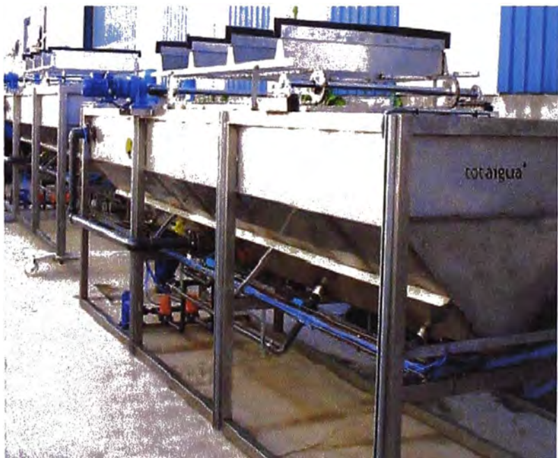
Fig. N° 6.1. Equipo para la depuración: Flotación por aire disuelto
