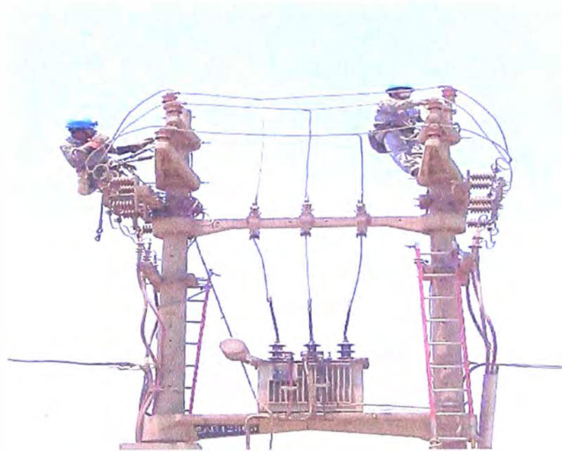
Fig. 3.1 Limpieza de aisladores
