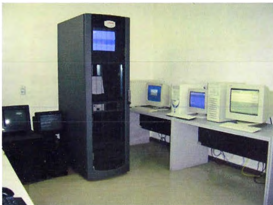
Ilustración 2.10: Data Center donde se ubicó la solución LMS
