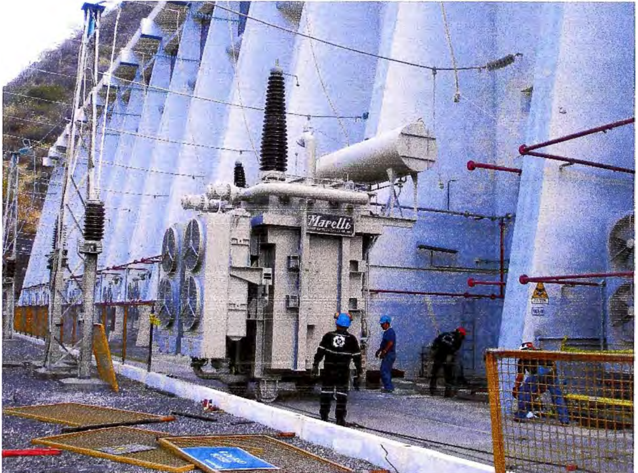
Fotografía B.1 Celdas de los transformadores monofásicos de 40 MVA
