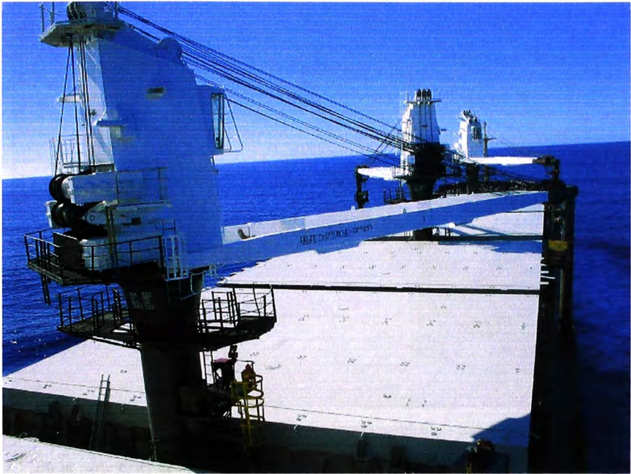
Fig. 3.1 Distribución de tambores de adujamiento de pluma, cuchara y gancho, de arriba hacia abajo respectivamente,
