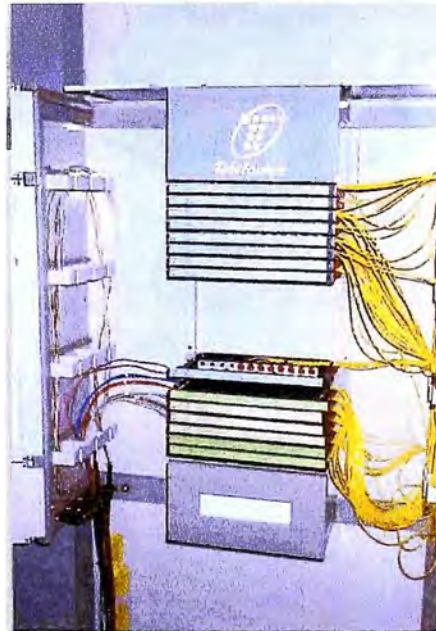
Figura 1.21 Repartidor óptico (ODF)
