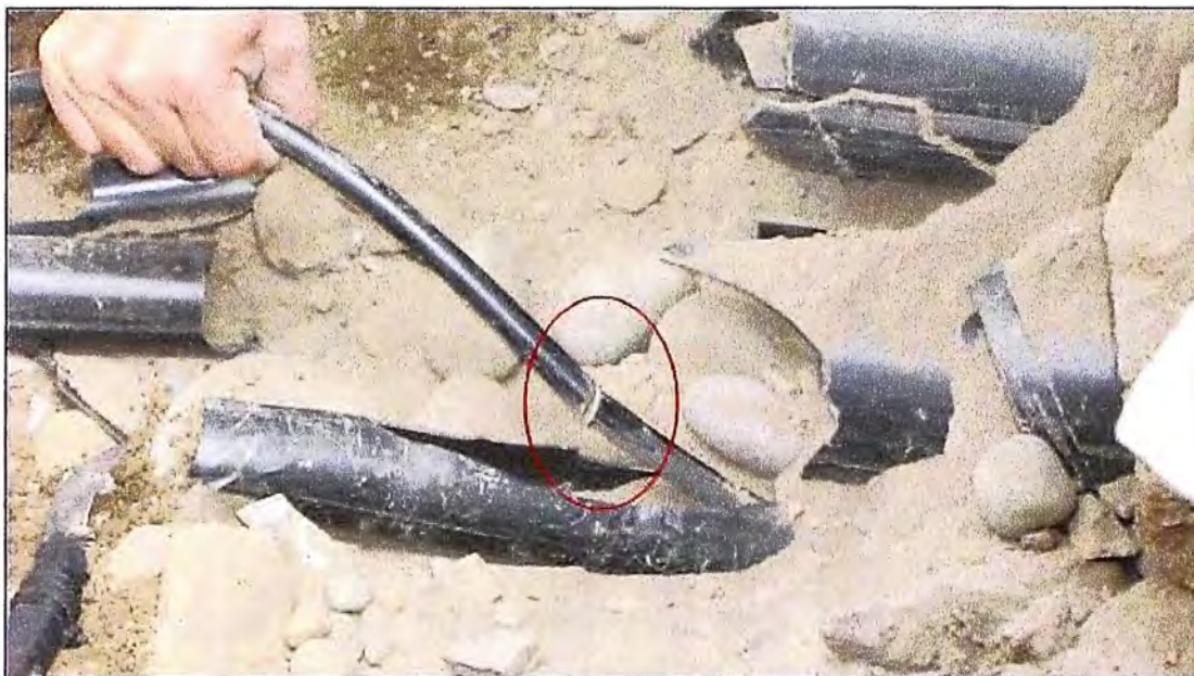
Figura 2.2: daños a la fibra óptica por intento de robo
