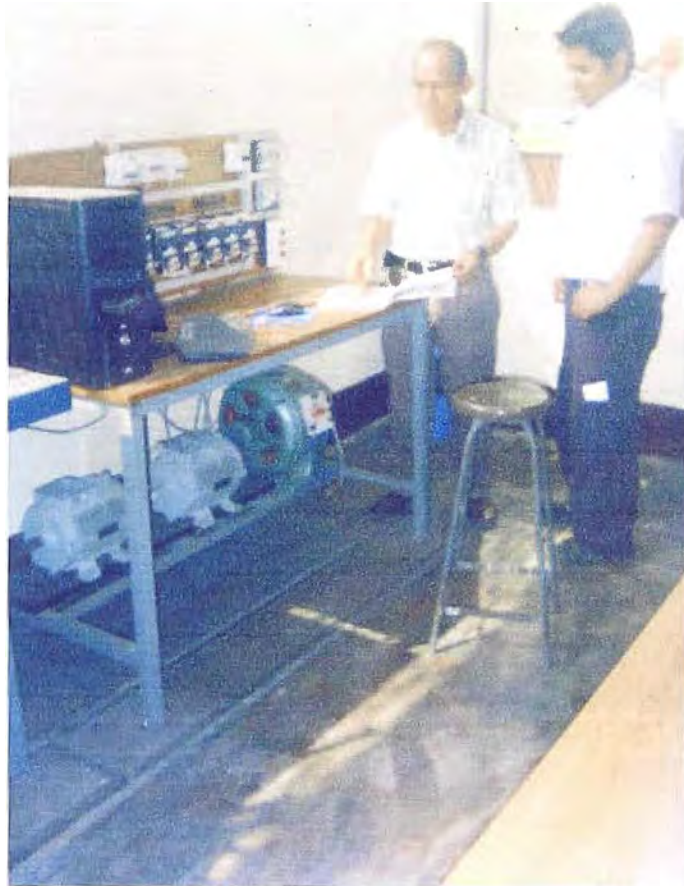
Fotografía C.8 Supervisión del arranque de los motores con el Pico PLC por parte del ingeniero Luis Rojas
