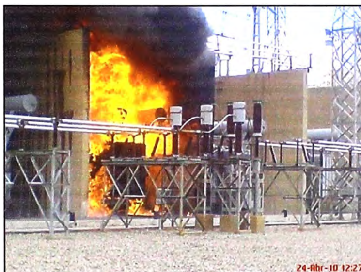
Figura 4.10: Imagen del transformador afectado por la falla
