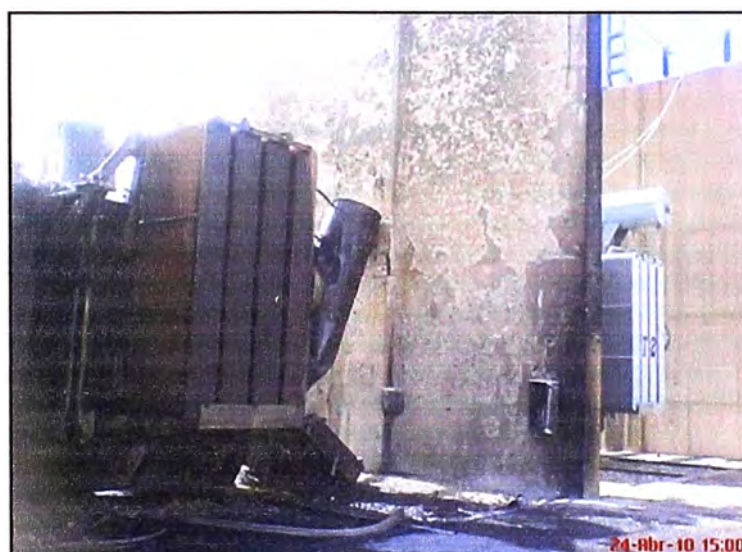
Figura 4.11: Resultado del transformador incendiado
