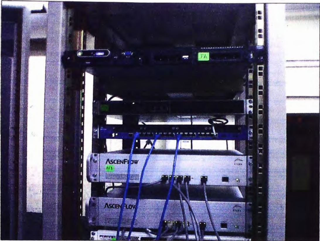
Figura 4.15 Disposición de los equipos dentro de su gabinete en la sala de datos
