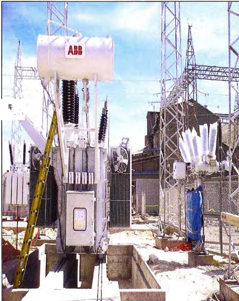
Figura N° 5.7: Autotransformador con terciario.
