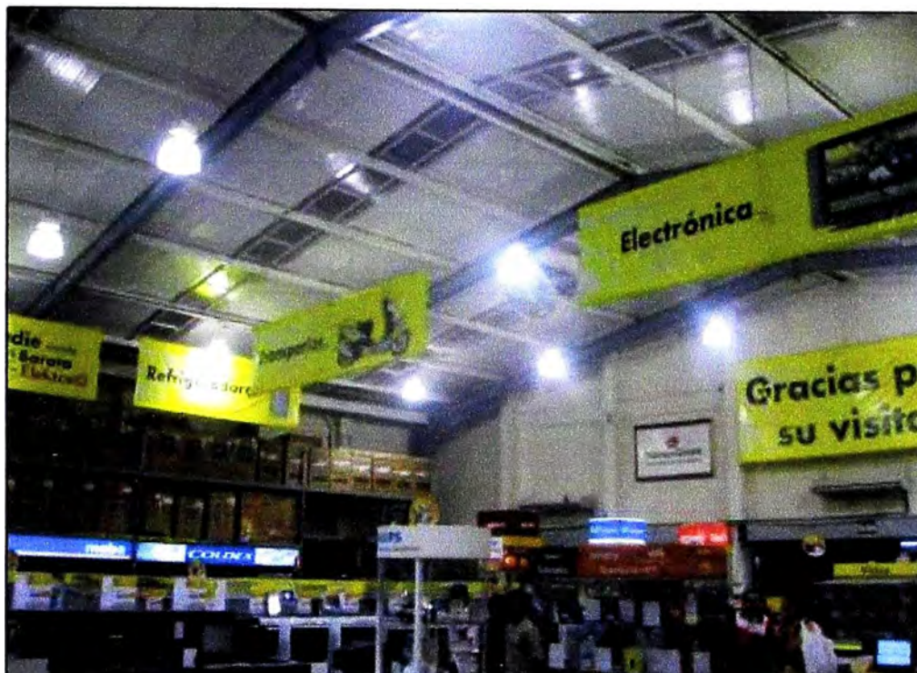
Figura N°3.72: Iluminación Interior Sala de Ventas
