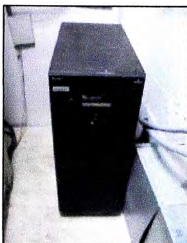
Figura N°3.76: Ups Alimentación de equipos de Cómputo y Comunicaciones
