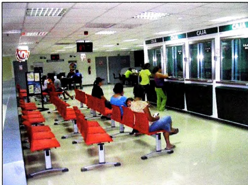
Figura N°3.73: Iluminación Interior Zona de Banco
