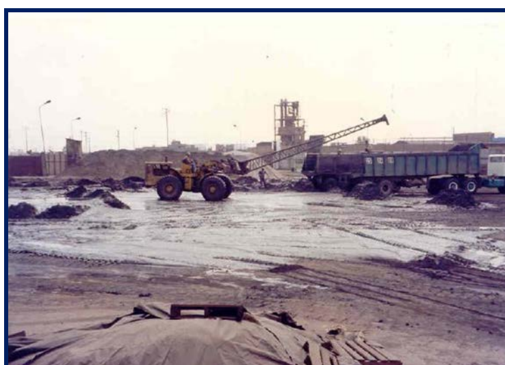
Figura 1. Descarga de concentrados de plomo al aire libre sobre las losas dañadas (Año 2000)
