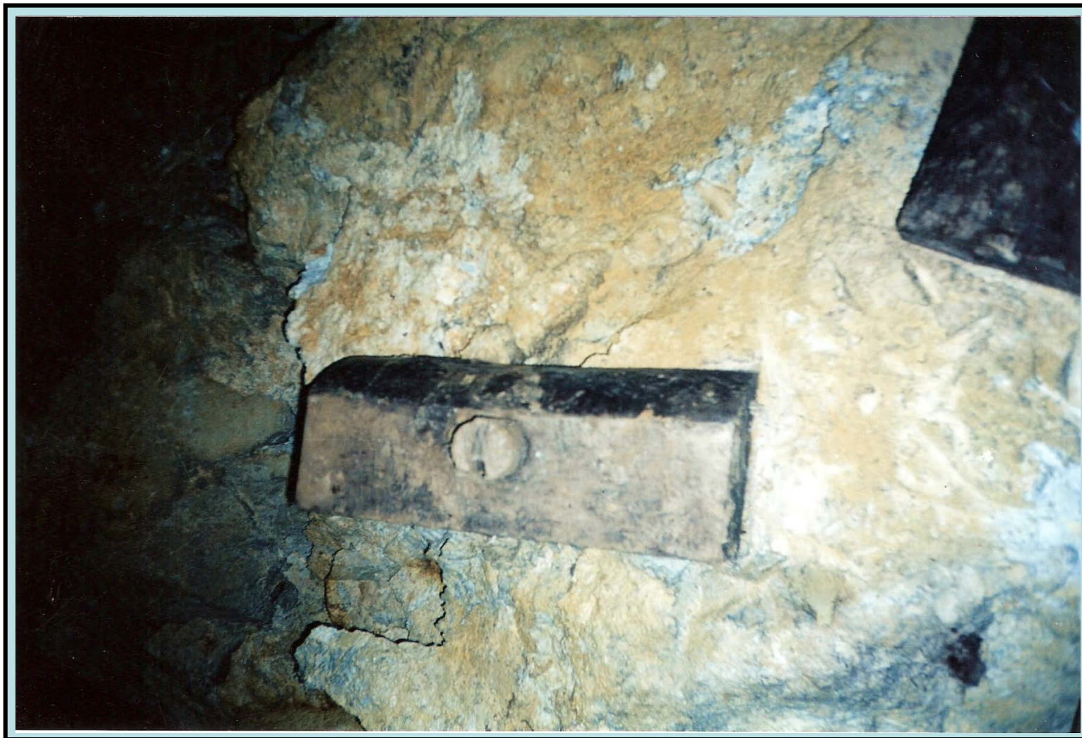
Sostenimiento con Perno de madera y plantilla de madera en una labor antigua este sostenimiento fue aplicado entre los años 50 del siglo pasado
