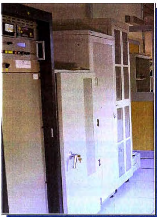
Figura 1.7 Gabinete en la Sala Técnica
