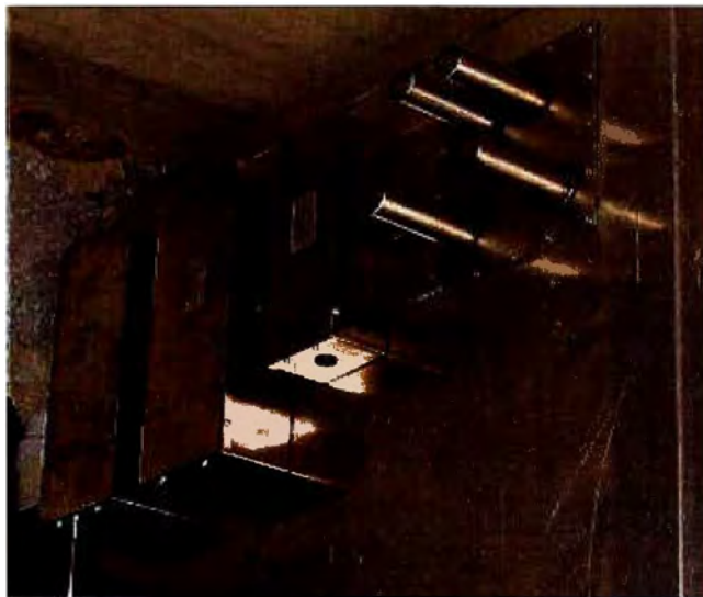
Figura 2.10 Entrada Filtros Eléctricos
