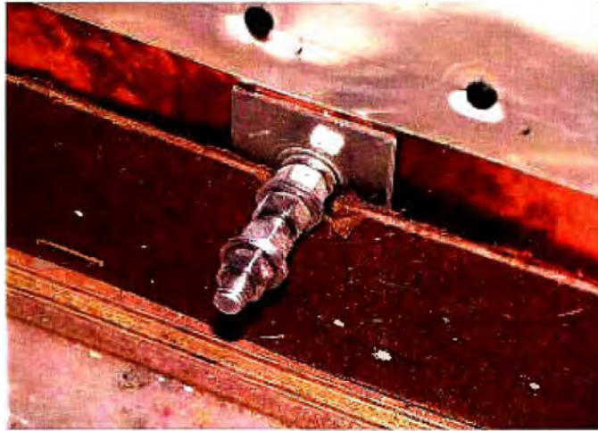
Figura 2.9 Conexión a Tierra.
