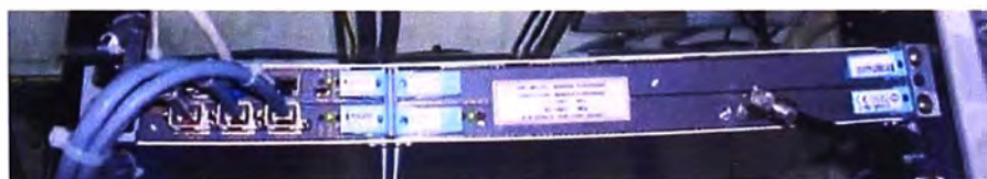
Figura 3.34 Equipo Minilink Ericsson TN en estación EBC Milpo (Fuente: Elab. propia)
