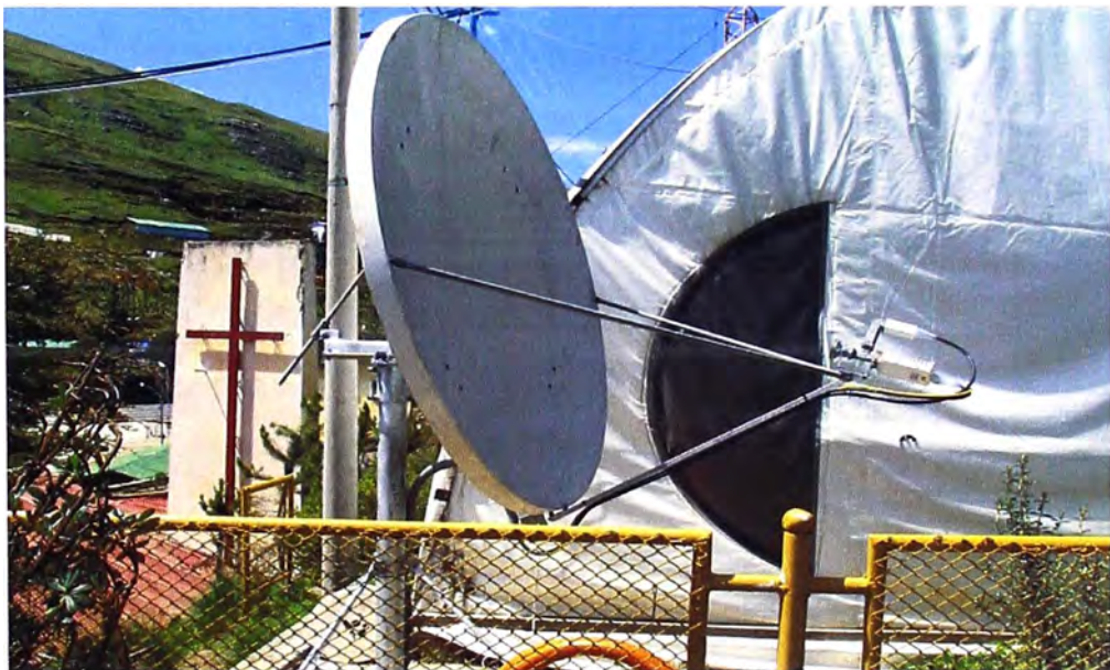
Figura 3.46 Imágenes de unidad instalada (Fuente: Propia)
