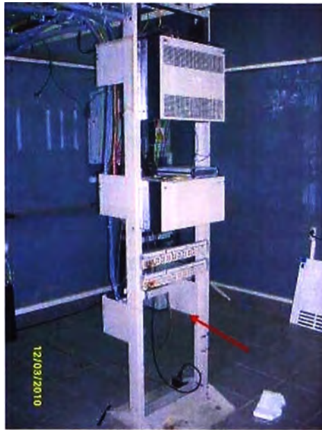
Figura 3.28 Sala de sistemas y rack disponible para equipos (Fuente: Elab. Prop.)
