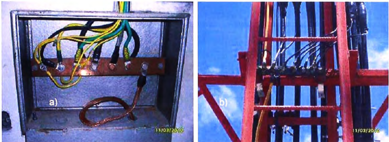
Figura 3.6 Aterramientos: a) Sala; b) Torre (Fuente: Elab. Propia)
