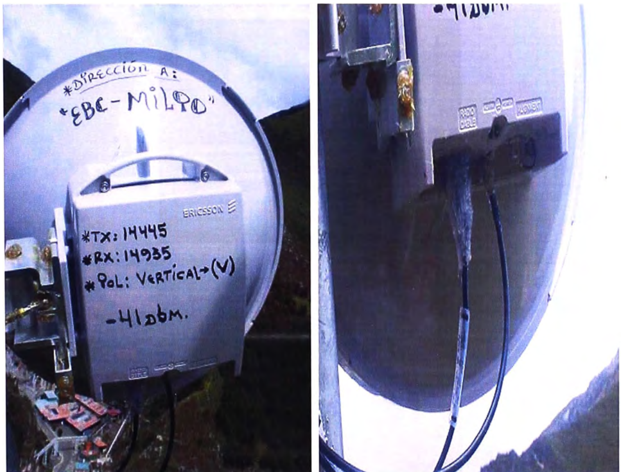
Figura 3.26 Antena en EBC Chicrín con dirección a EBC Milpo (Fuente: Elab. propia)
