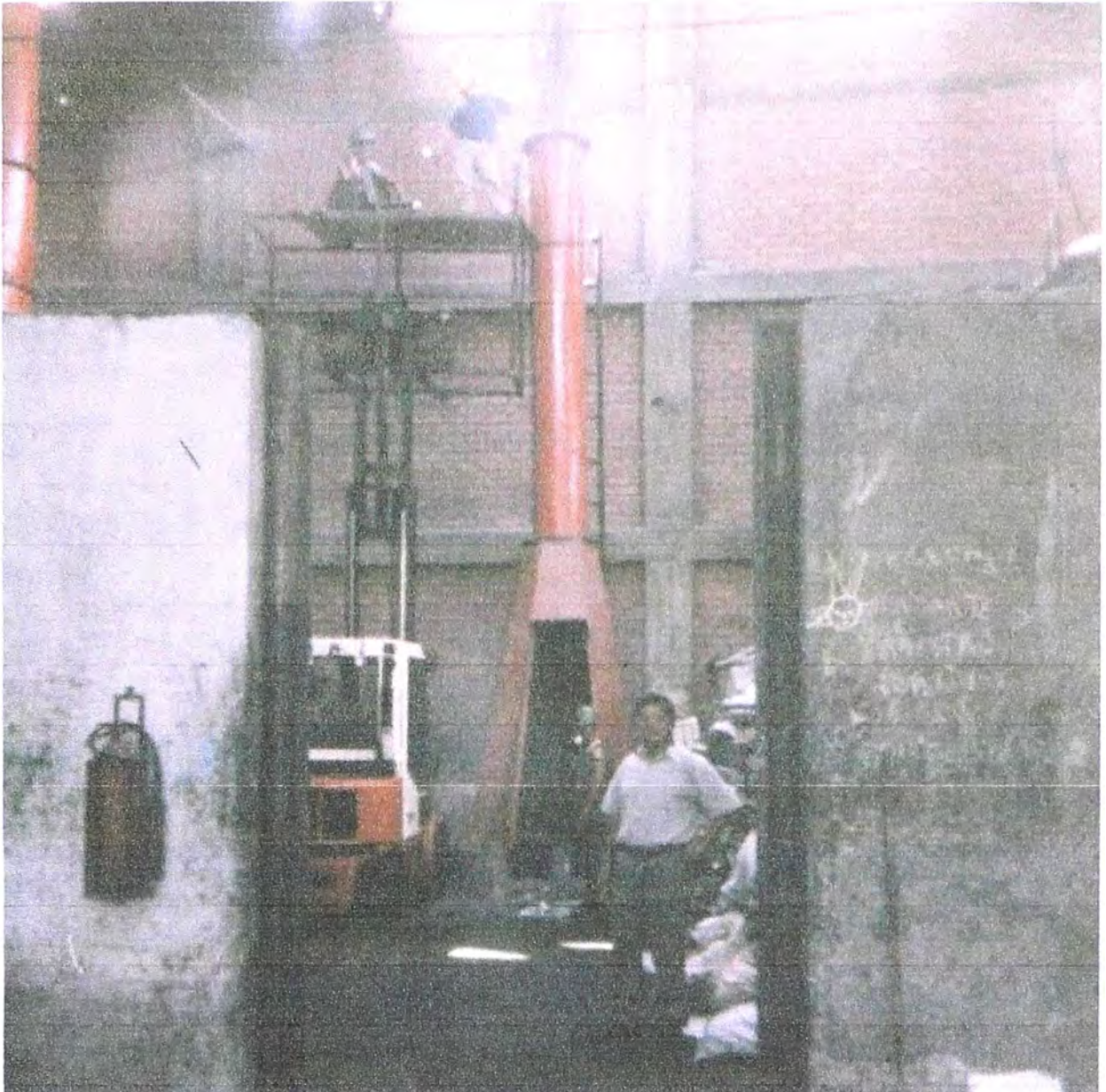
Figura B: Vista de un monitoreo clásico de emisiones gaseosas en la chimenea
