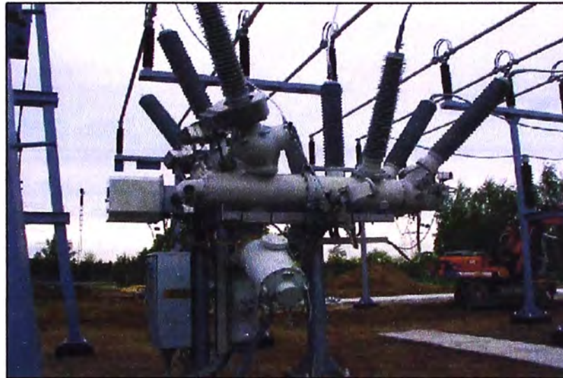
Fig. 2.3 Subestación Híbridas Compactas
