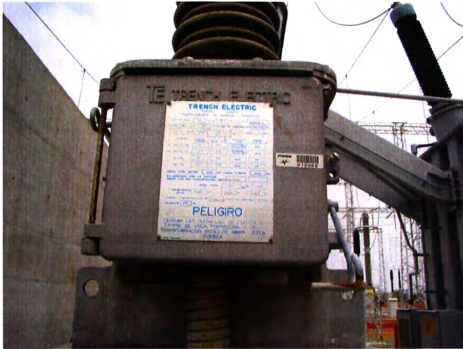
Figura 1.4. Transformador de Tensión TT-627
