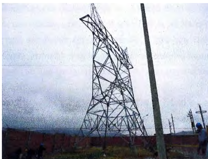
Figura 4.7 Torre ubicada en la S.E. Chilca
