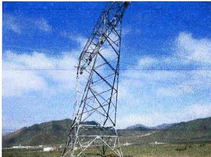
Figura 4.2 Torre ubicada entre V-05 y V-06
