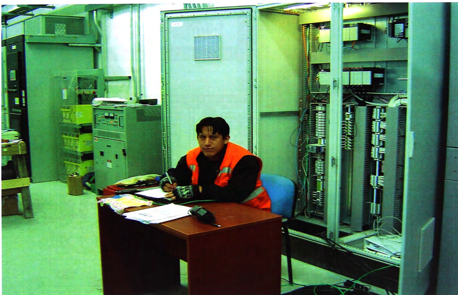
Figura 1.4 Sala Eléctrica donde se encuentra el CCM del proyecto (fuente: minera Antamina, personal)
