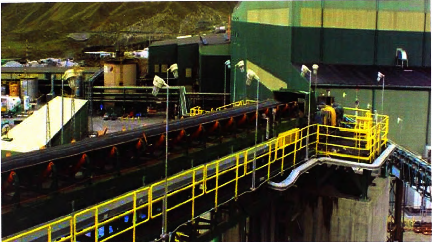
Figura 1.7 Faja transportadora 317-CVB-033 (fuente: minera Antamina, personal)
