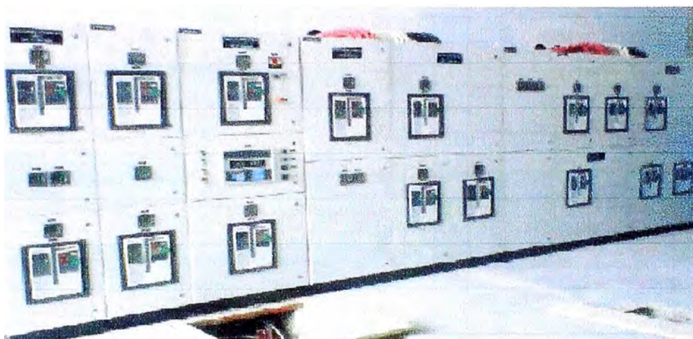
Figura 3.2 Vista de tablero de transferencia
