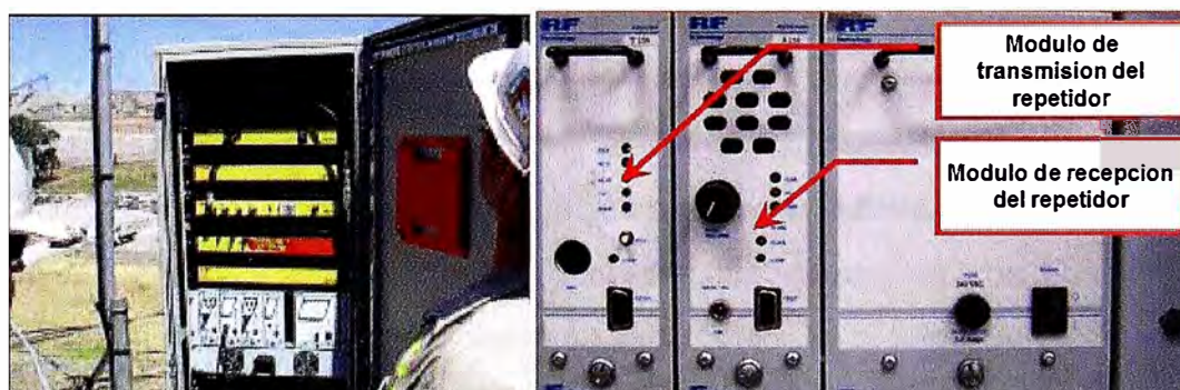
Fig. 2.17 Ubicación de los repetidores en el HeadEnd (Fuente www.minesite.com.au ).
