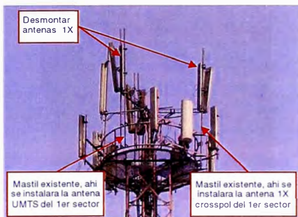
Fig. 3.32 Adecuación de mástiles para UMTS en la EBC Cáceres. Fuente: Elaboración Propia
