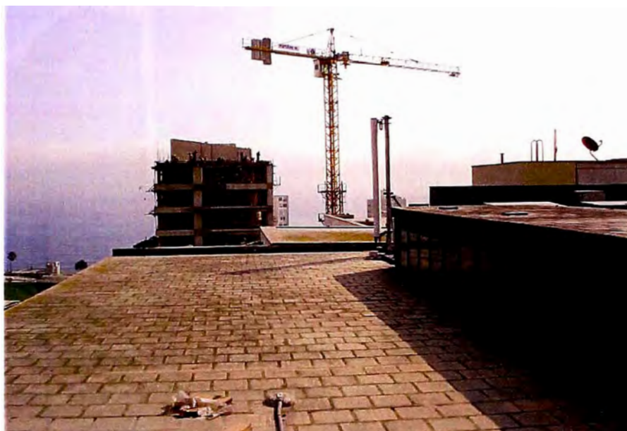
Fig.2.3 EBC Lavalle, edificio que se construye y que produce obstrucción de la señal de una de las antenas instaladas.
