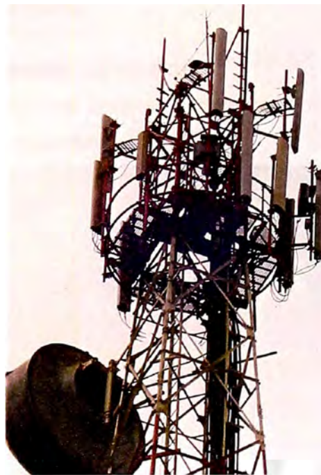
Fig.2.2 Torre celular donde no hay espacio para instalar más antenas. Fuente: Elaboración propia
