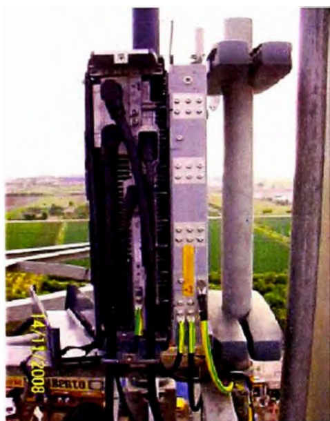
Fig. 3.33 Jumpers conectado en los RF MODULES Fuente: Elaboración Propia
