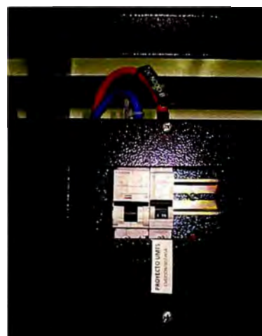
Fig. 3.15 Eltek con Breaker para UMTS Fuente: Elaboración Propia
