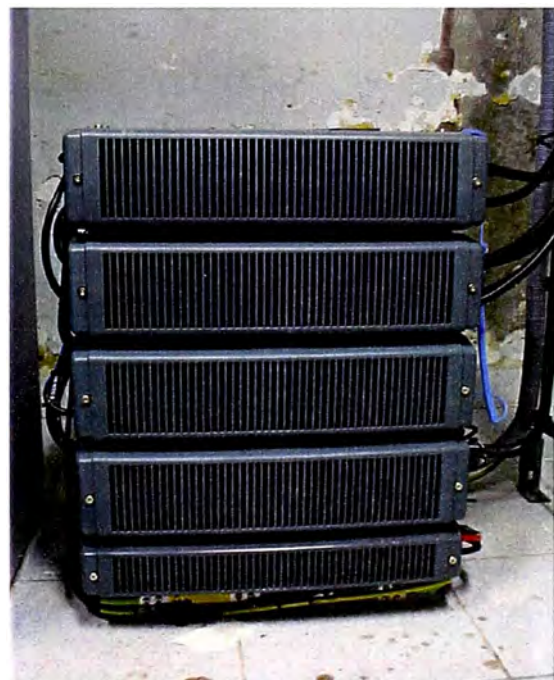
Fig.1.10: Nodo B de Nokia Flexi WCDMA. Instalada en la EBC Bertolotto Fuente: Elaboración propia
