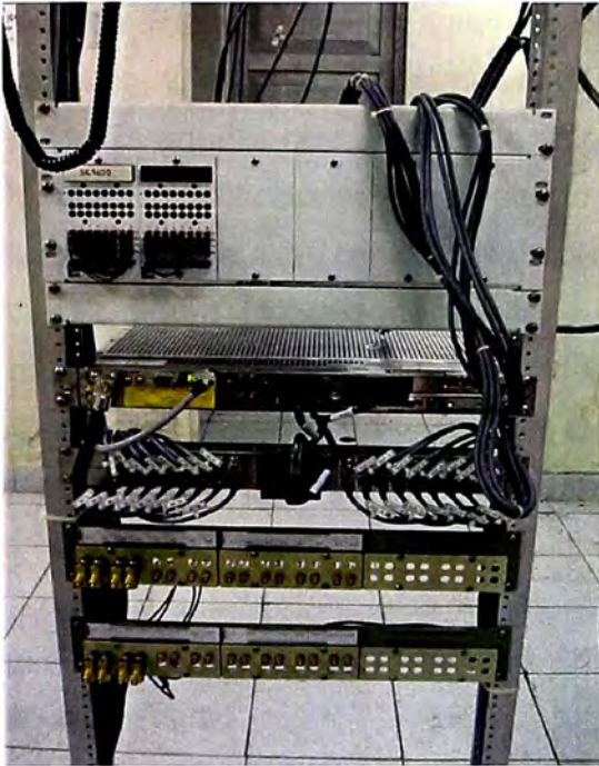
Fig.1.11 Equipo de transmisión en Sala celular de una EBC en Lima. Fuente: Elaboración propia
