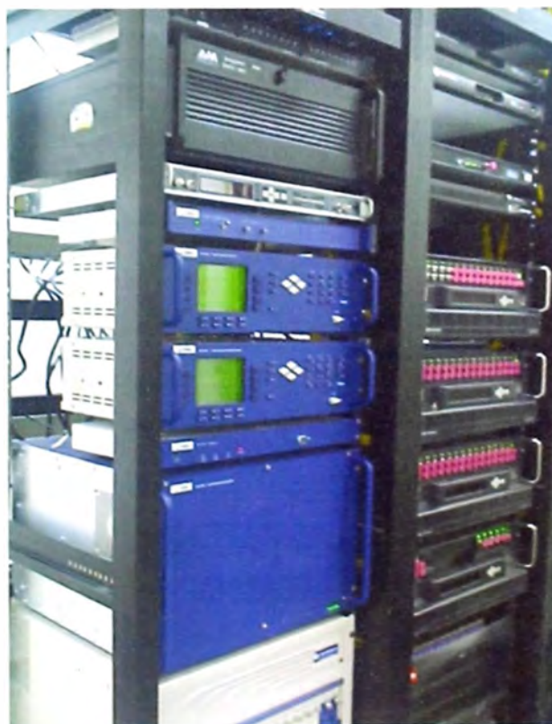
Fig. b.4 Gabinetes con Terminaciones de Fibras y equipos
