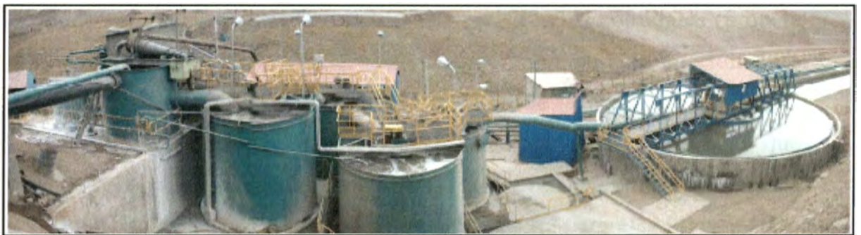
Fig. 6 Foto de la Planta de Neutralización NCD del Túnel Victoria
