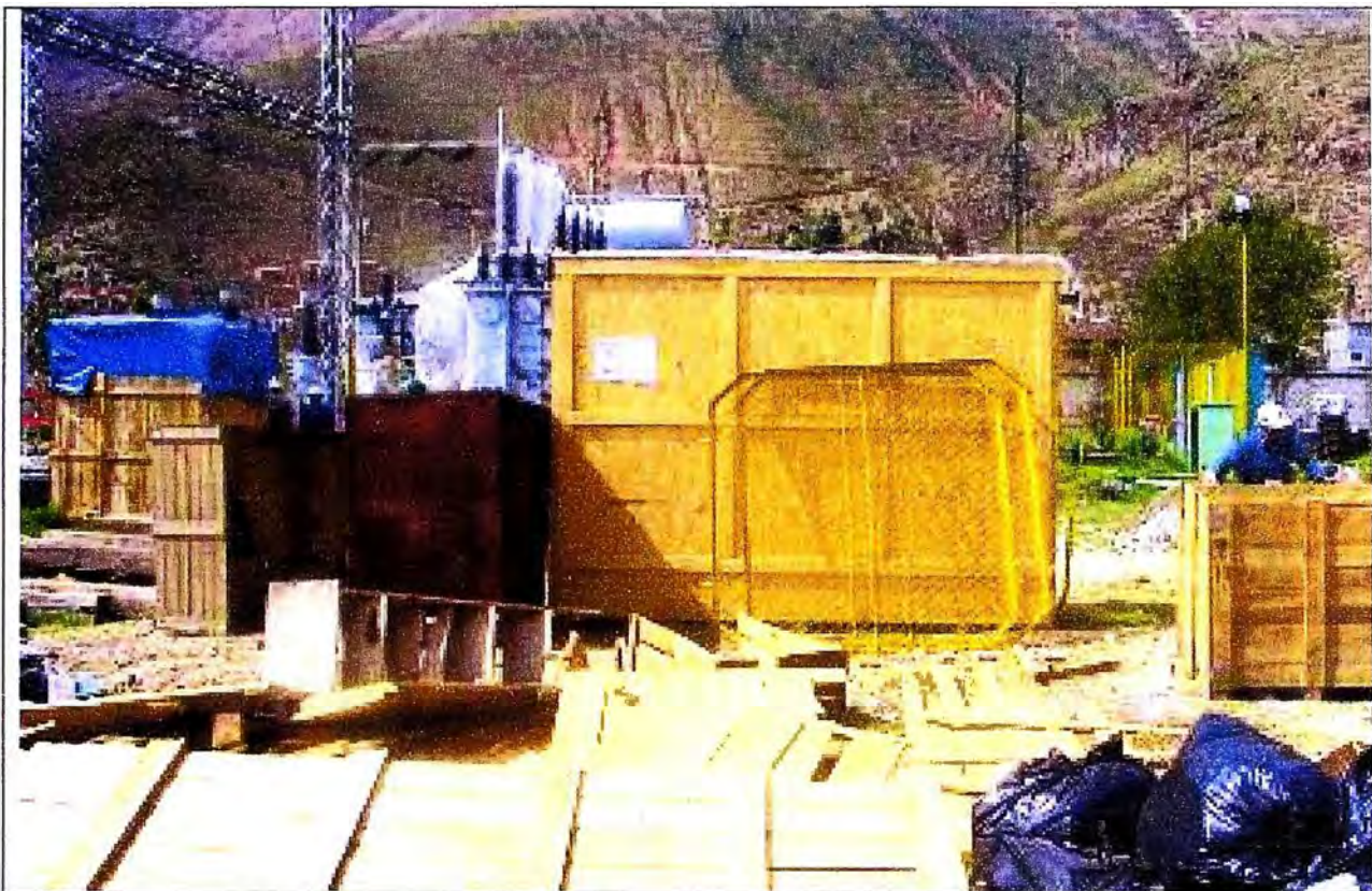
FOTO N° 5: SET Ninatambo ELECTROCENTRO: Equipos de maniobra 44 kV, encajonado lista para su montaje para energizar transformador de potencia en reserva.
