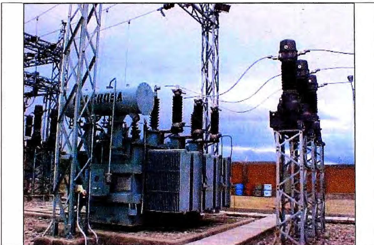
FOTO N° 3: Vista del transformador de potencia DELCROSA de la SET Pasco, de 50/22.9 kV, 12 MVA, fuera de servicio.
