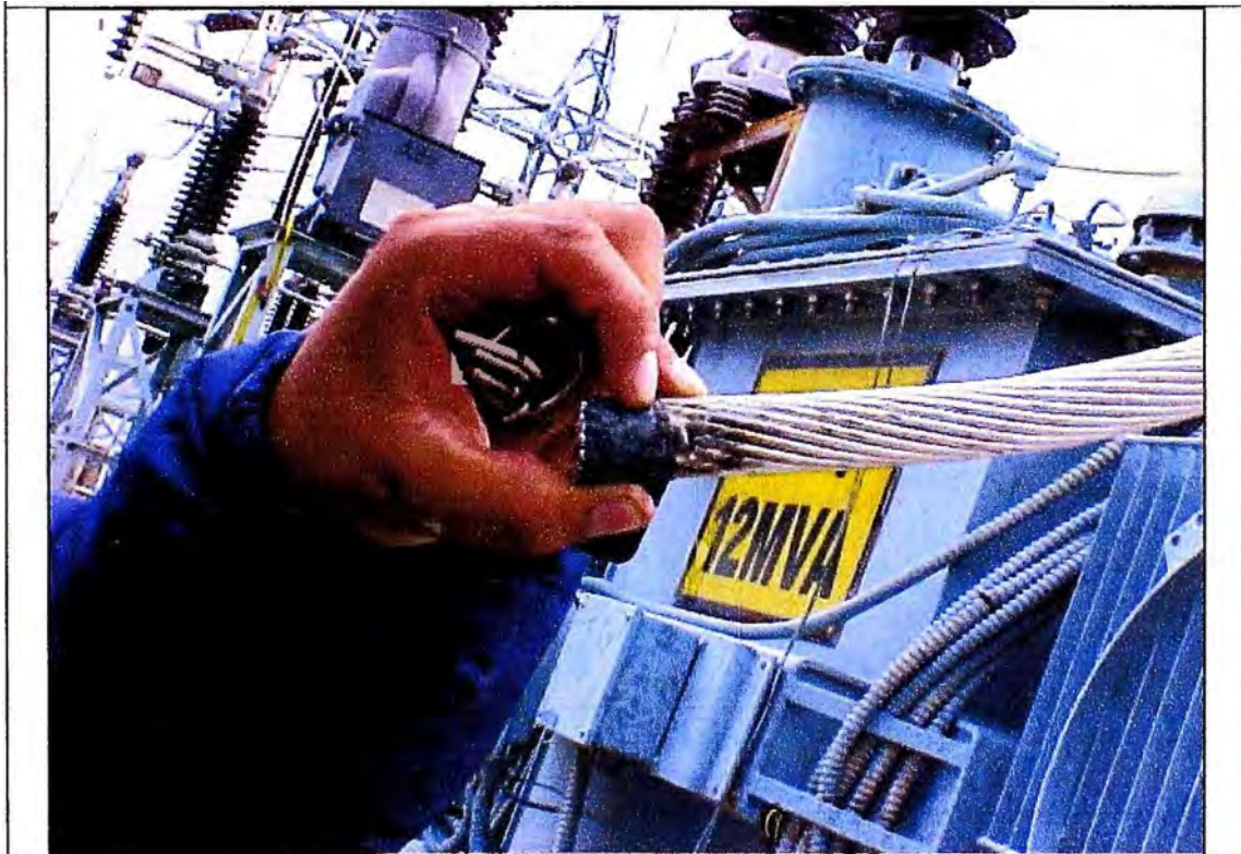
FOTO N° 2: Vista del conductor de aluminio de bajada al pararrayos fase "R", lado de 22.9 kV, se aprecia huella de descarga eléctrica.
