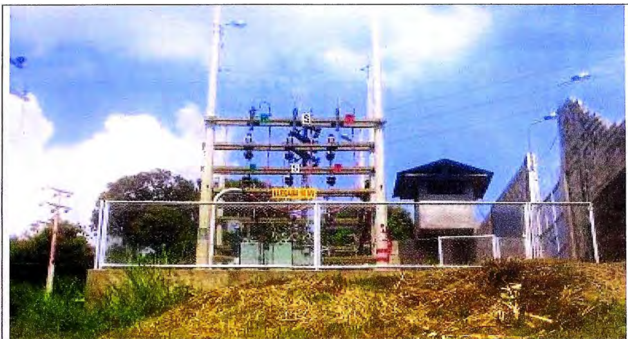
FOTO N° 1: Se muestra la SED Tingo María, 10.5/22.9 kV, para alimentar Tingo María rural, que es conectado con cable subterráneo de la barra 22.9 kV. De la misma forma son conectados los alimentadores para la ciudad Tingo María de la barra 10.5 kV desde la SET Tingo María REP.
