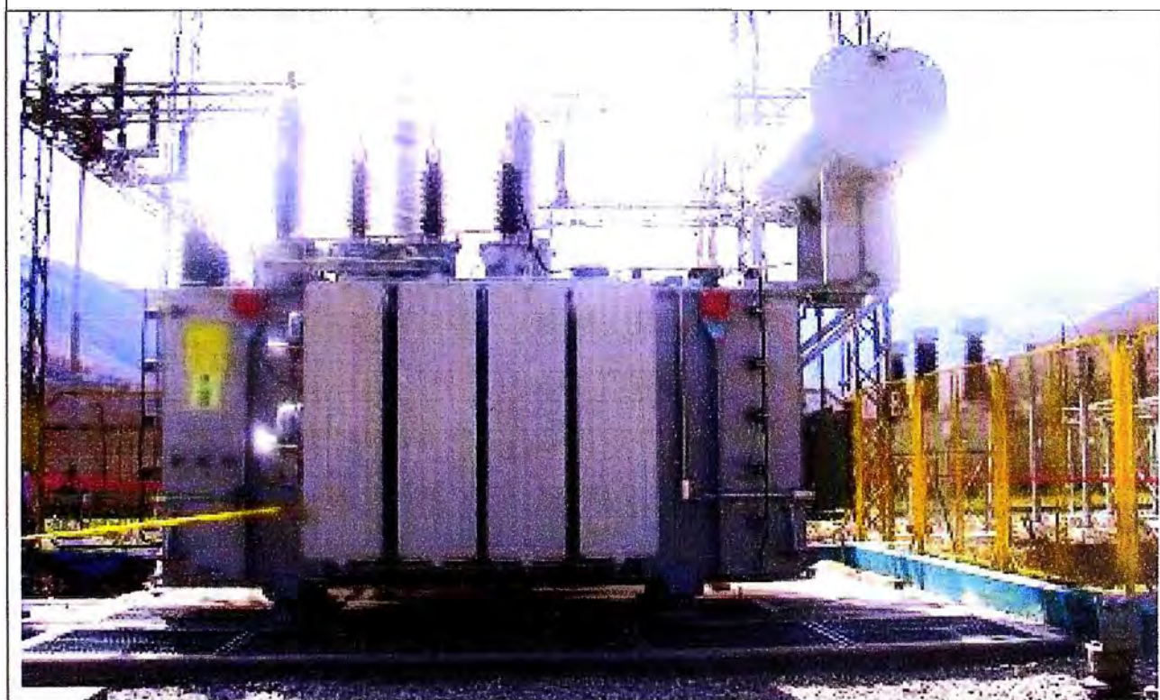
FOTO N° 4: SET Ninatambo ELECTROCENTRO: Transformador de potencia de reserva instalado con base definitiva. En caso de requerirse en otros servicios eléctricos se trasladará tal como está declarado en su PCO.
