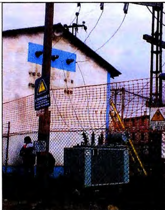
FOTO N° 4: Vista del transformador de 2 MVA, 12/22.9 Kv, trasladado desde Huariaca, instalado al costado de la S.E. 1° de Mayo; entro en operación a las 02:50 a.m. del 03/04/2008.
