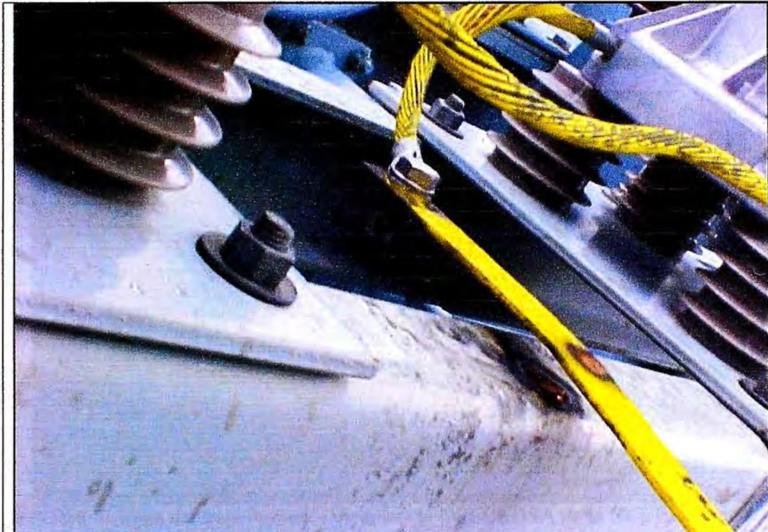
FOTO N° 1: Vista de la platina de cobre de puesta a tierra y de estructura metálica del transformador DELCROSA 12 MVA, con huellas de descarga eléctrica.
