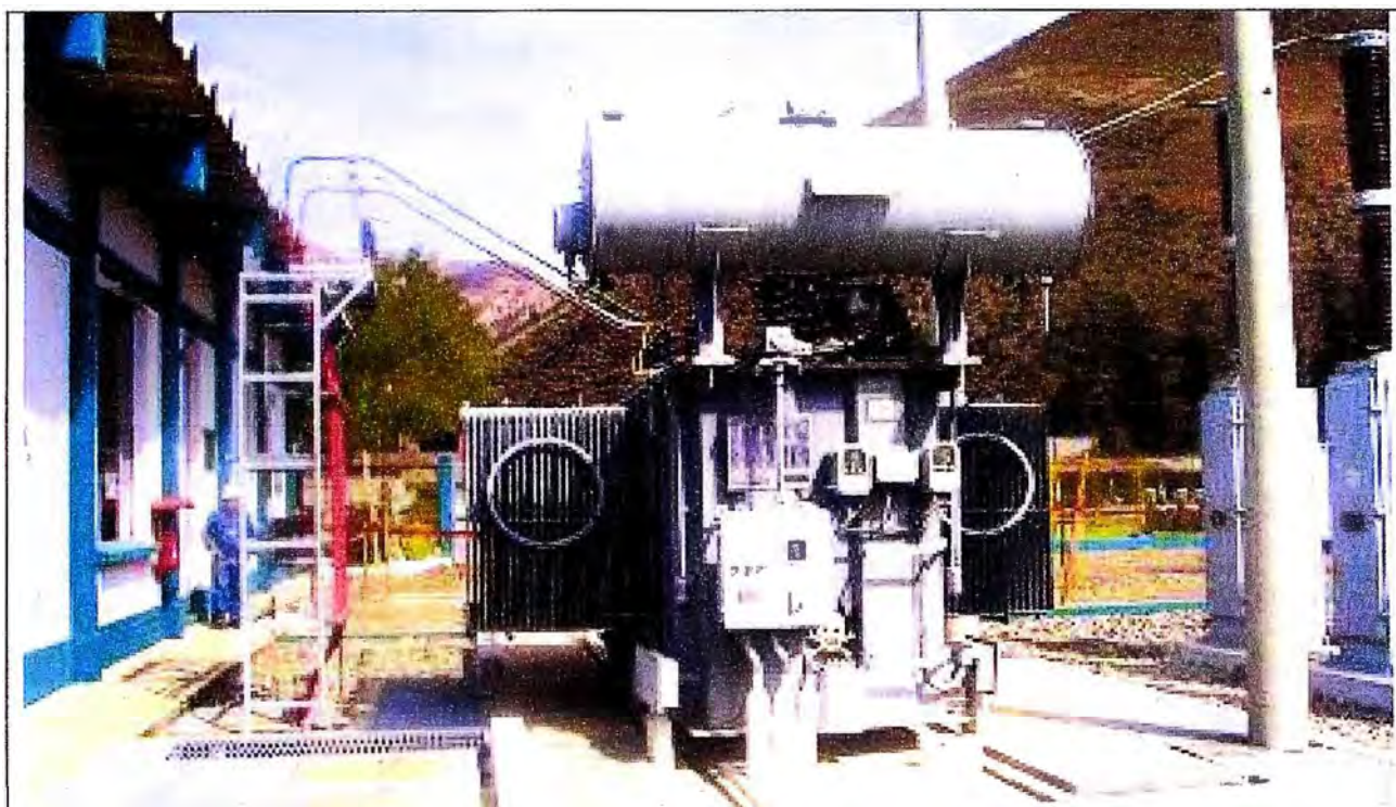
FOTO N° 3: SET Ninatambo ELECTROCENTRO: Transformador de potencia en servicio actual 44/10/22.9 kV, 10/5/5 MVA
