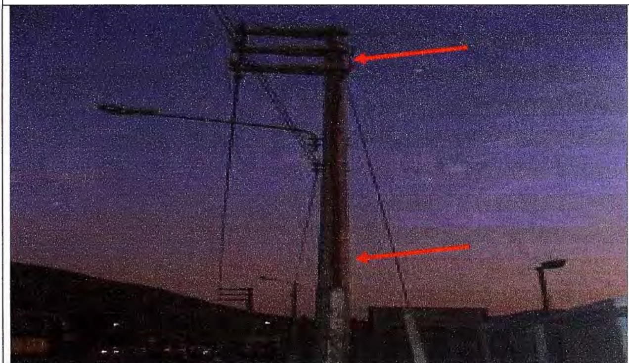
FOTO N° 2: Se muestra salida de los alimentadores en 10 kV en el primer poste para Huánuco ciudad, desde la barra 10.5 KV y Huánuco rural de la barra 22.9 kV desde la SET Huánuco.
