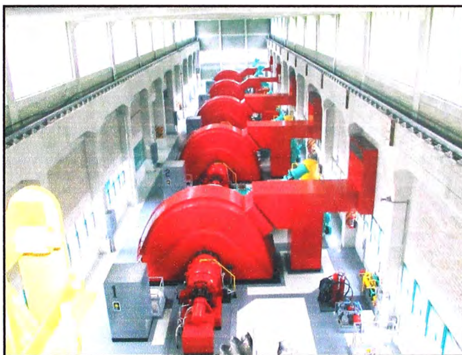
Fig. 4.2 Vista de la casa de máquinas de la CH Yaupi
