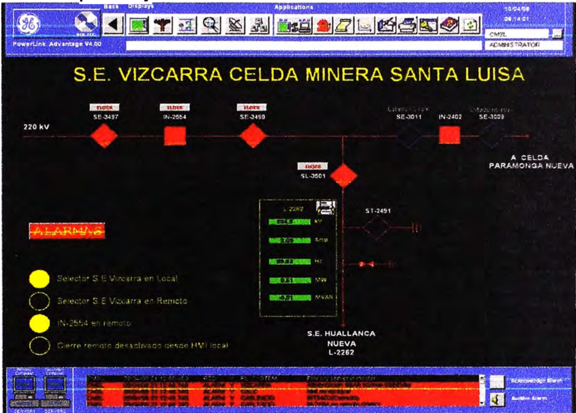
Pantalla 1: Supervision y Control de SE Vizcarra
