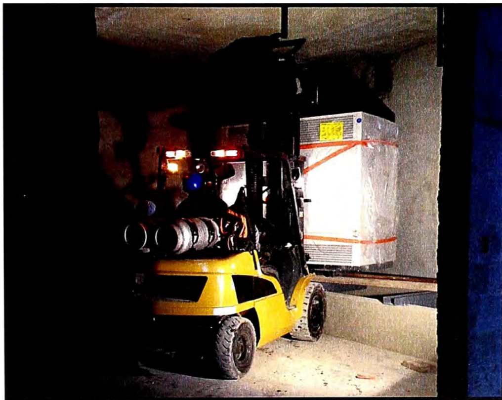
Fig. 3.16 (Foto 2 – Maniobra de Transformador de 1250 KVA)
