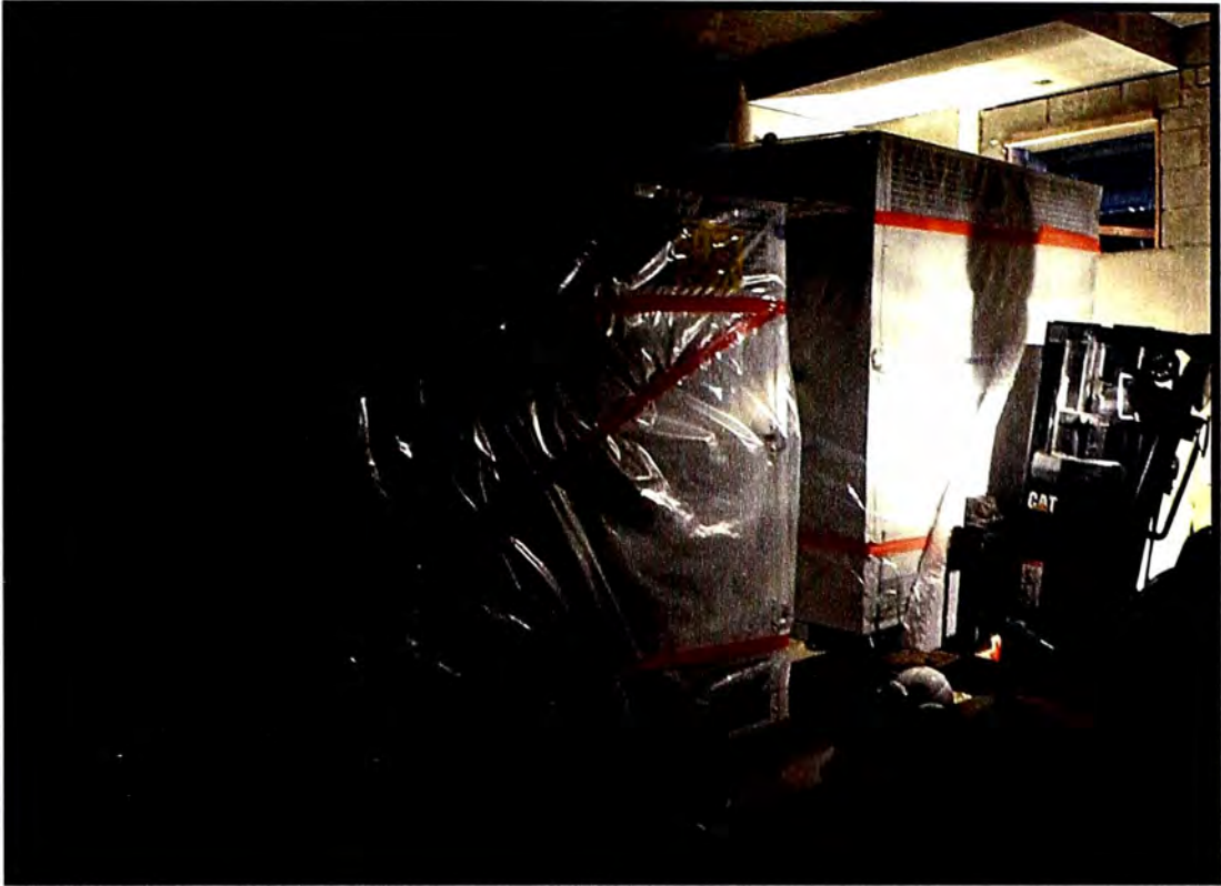
Fig. 3.18 (Foto 4 – Ubicación final de transformadores de 1250 KVA)
