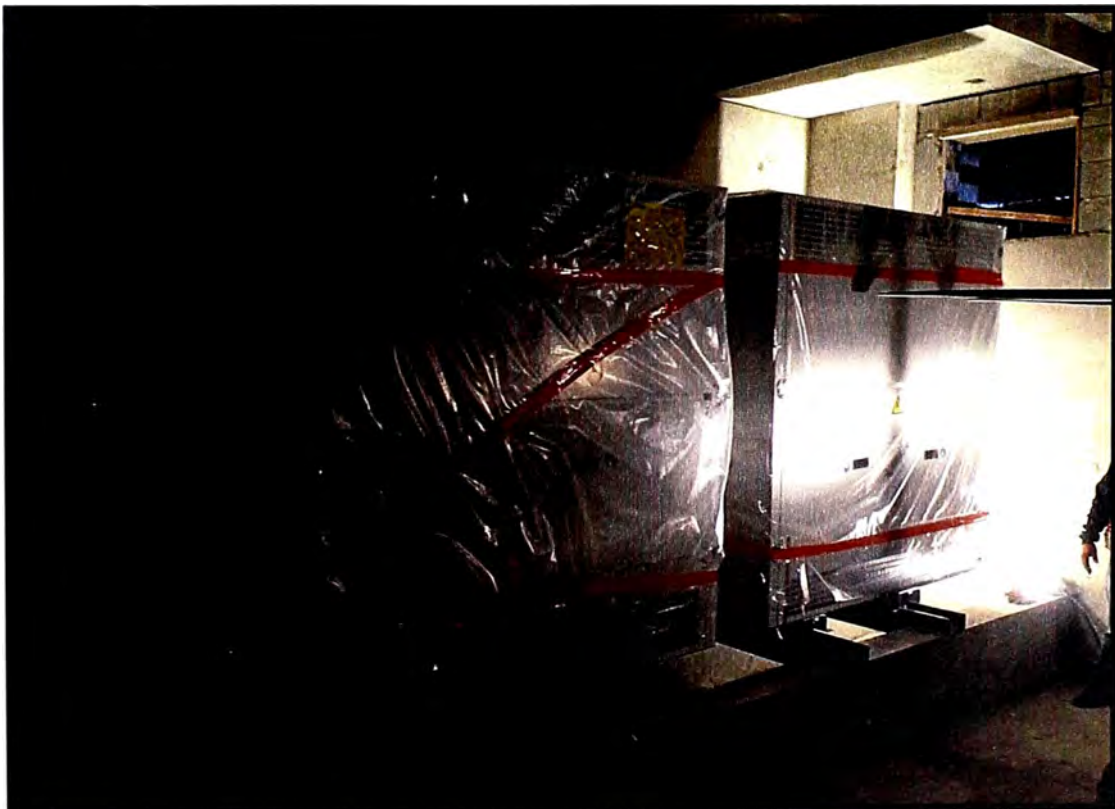
Fig. 3.19 (Foto 5 – Ubicación final de transformadores de 1250 KVA)
