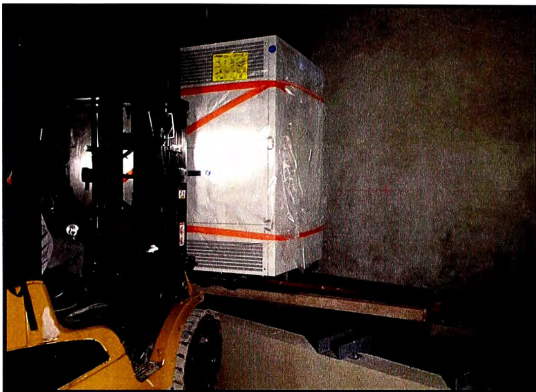
Fig. 3.15 (Foto 1 – Maniobra de Transformador de 1250 KVA)
