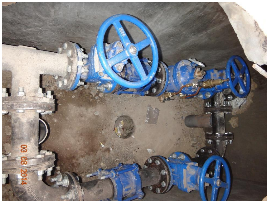
Figura N° 28: Se puede apreciar la presentación de la instalación de accesorios y válvulas de la cámara reductora de presión.
