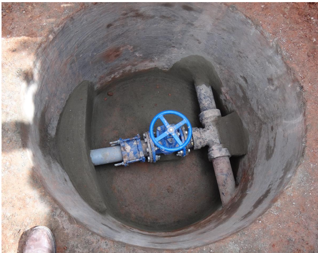
Figura N° 18: Cámara de purga en tubería de hierro dúctil, en la cota más baja.
