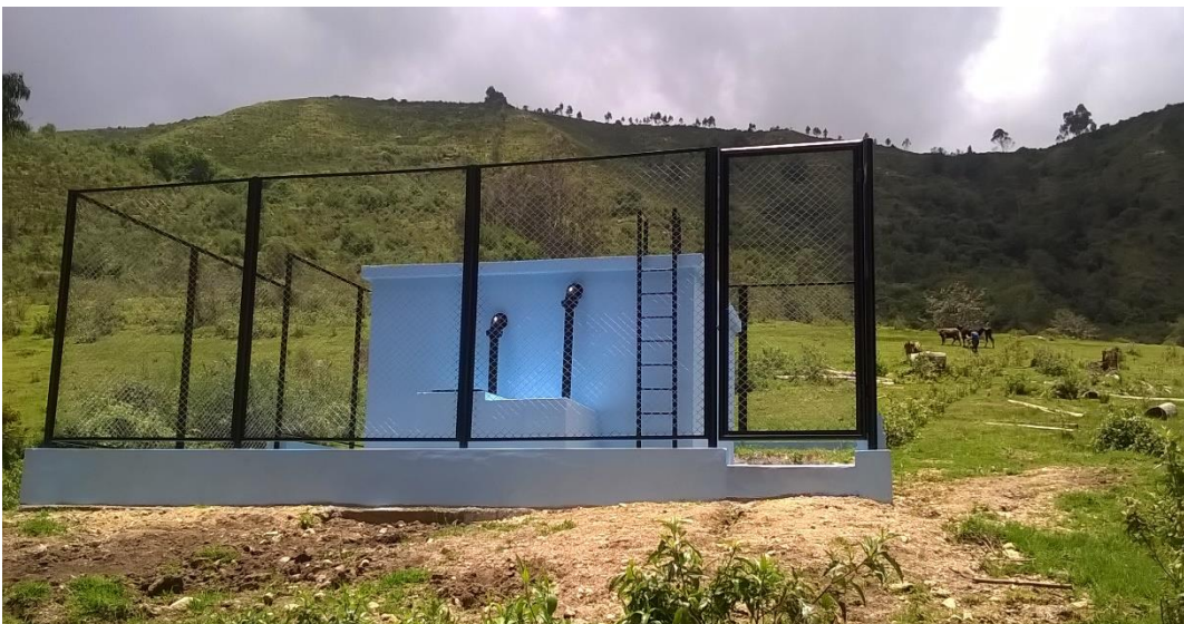
Figura N° 23: Vista del reservorio de 45\text{m}^3 que abastecerá al C.P. Cunyacc.
