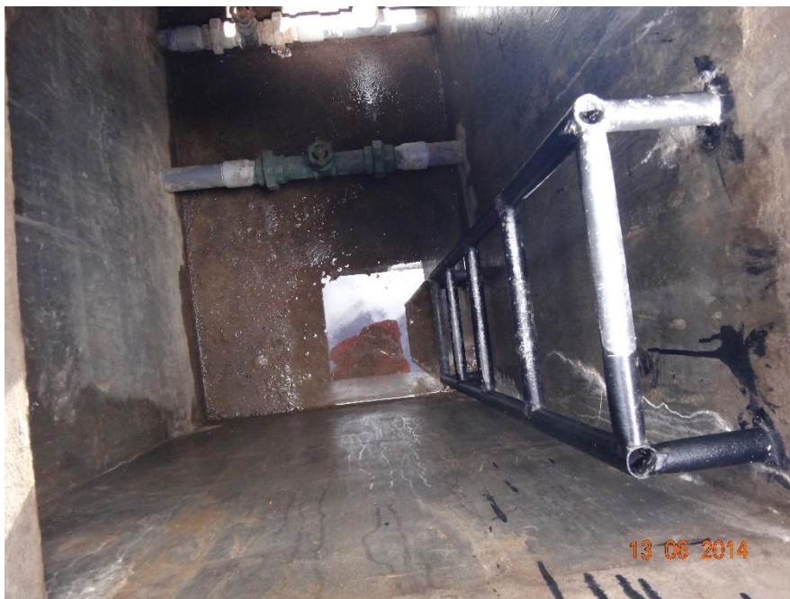
Figura N° 6: Captación existente con instalaciones hidráulicas deterioradas, vista desde arriba de la Figura N°5.
