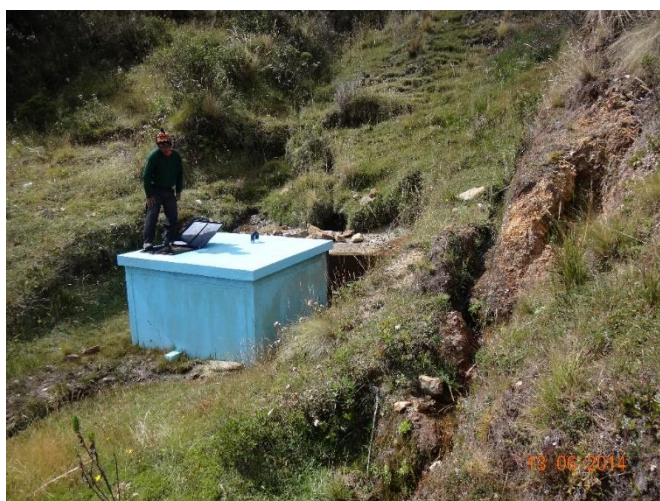
Figura N° 5: Captación existente en mal estado con filtro saturado, su ubicación pertenece al C.P. Pumachuco.
