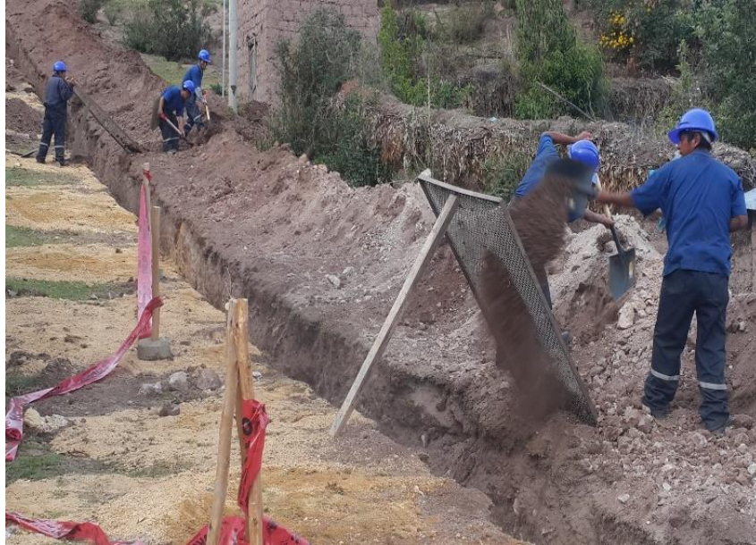
Figura N° 25: Se aprecia al personal zarandeando el material que presentaba piedras grandes, para el relleno de zanja.
