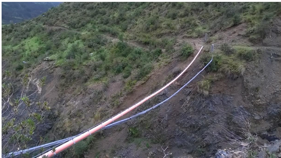
Figura N° 17: Pase aéreo de la Línea de Aducción, la tubería esta con forro de 160mm.
