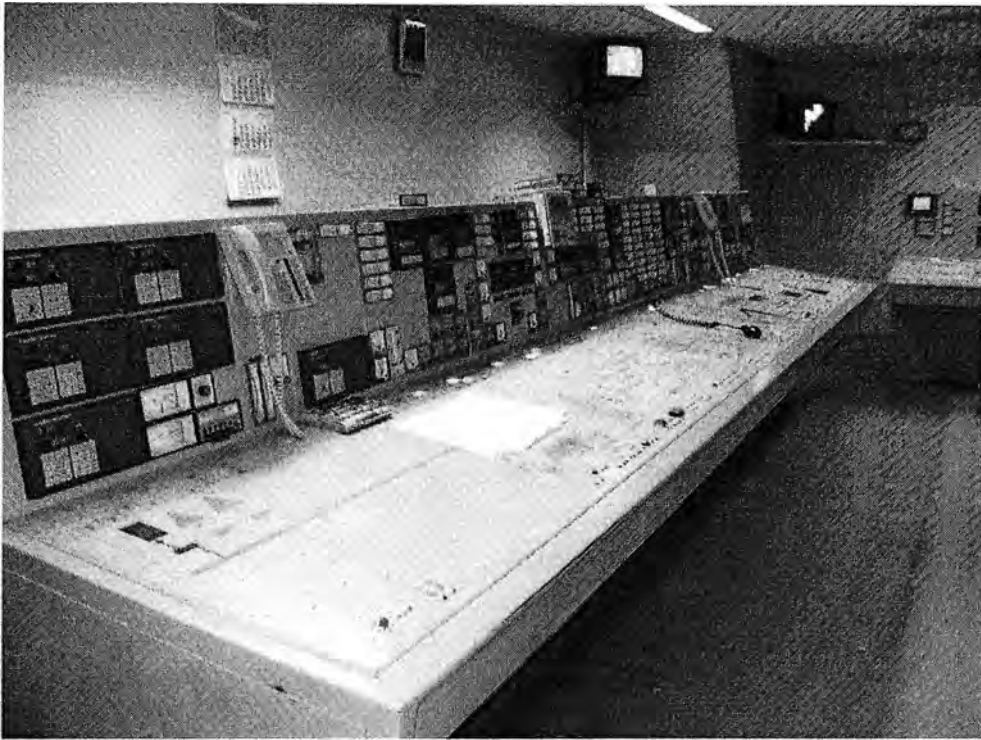
Fig. 3.1: Tablero de control actual
