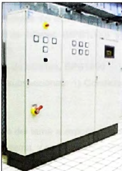
Figura 2.8 Unidad de control
