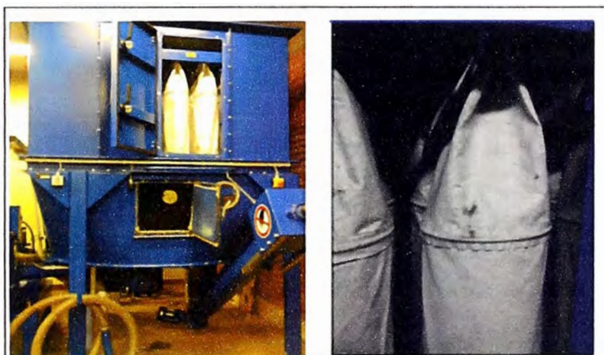
Figura 3.22 Filtros del sistema BDS 400
