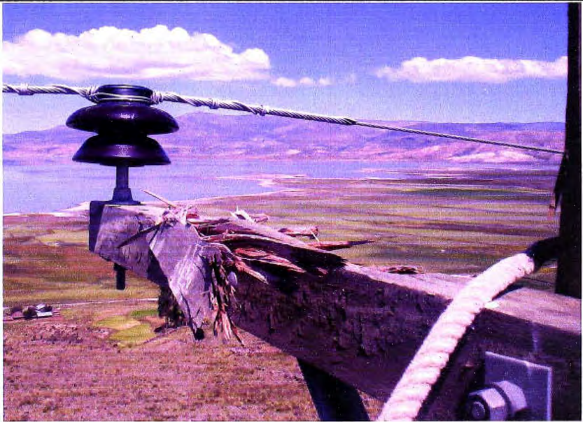
Foto 10: SER Coracora, crucetas afectadas por descargas atmosféricas
