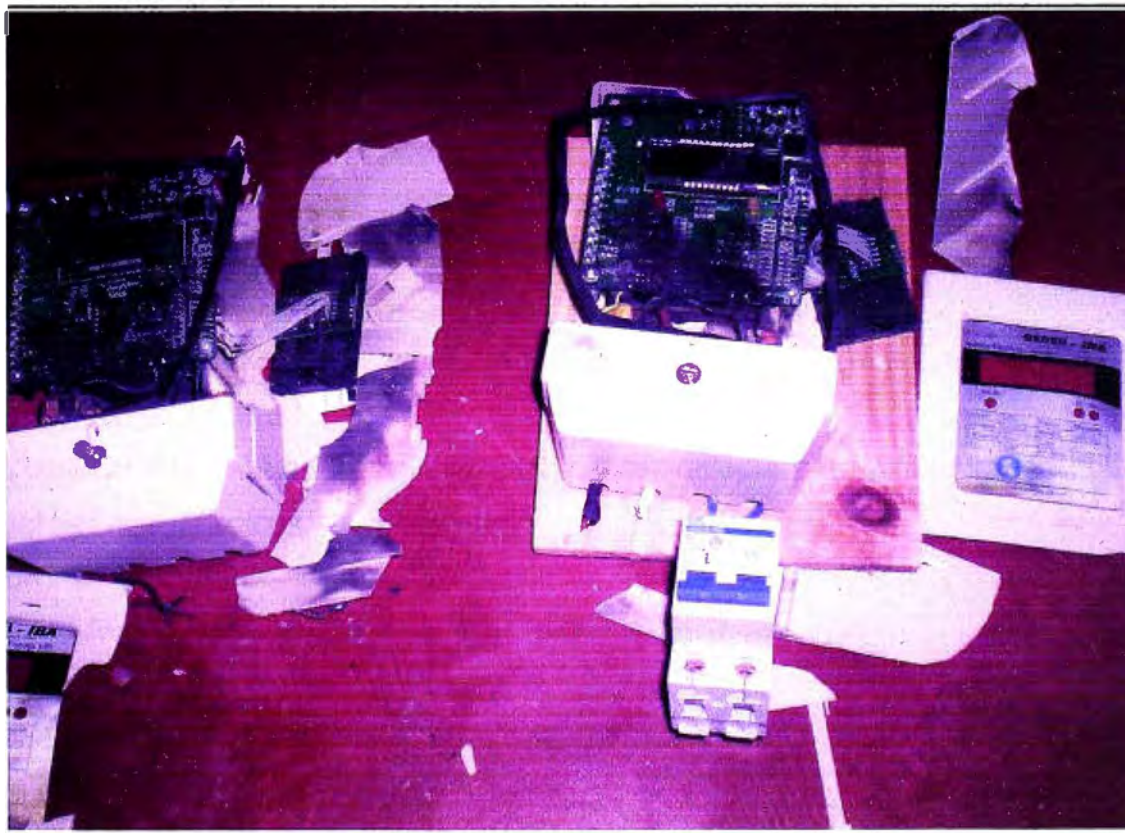
Foto 14: SER Coracora, consecuencias de descargas atmosféricas en baja tensión que incrementa la interrupción en BT
