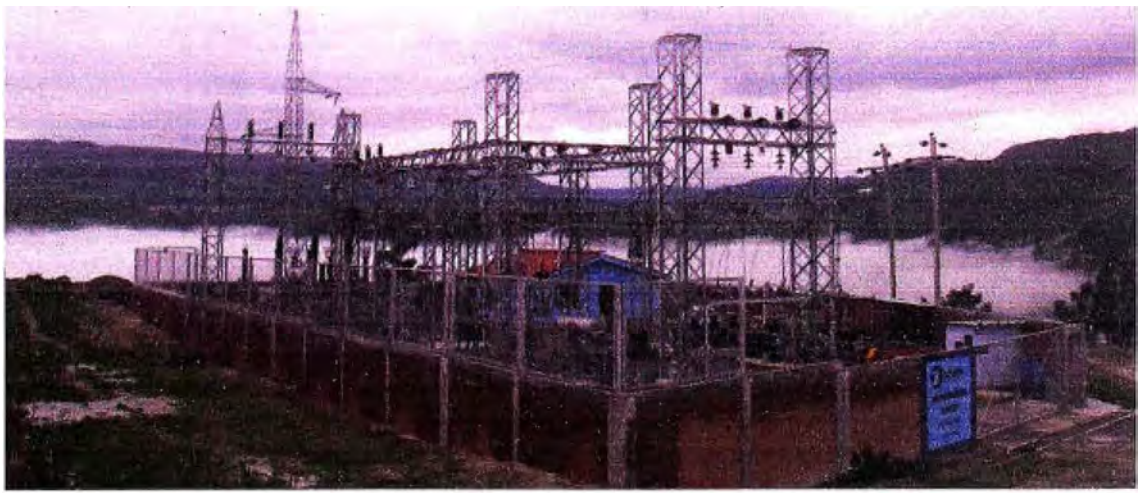
Foto 02: Subestación del SER, que presenta 03 niveles de tensión, 60, 22,9 y 10 kV
