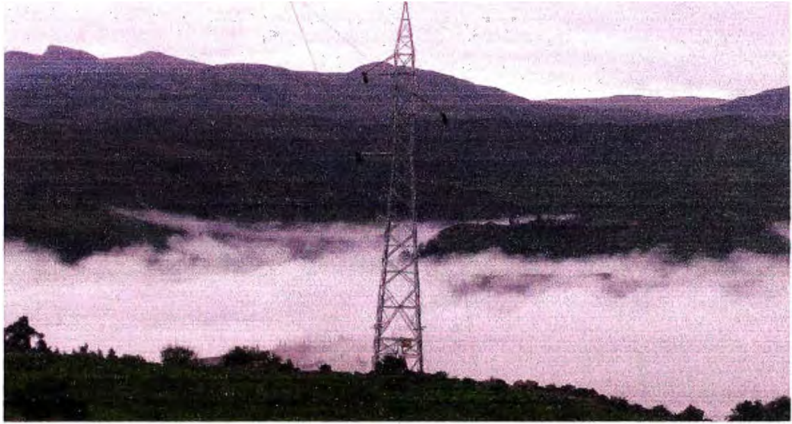
Foto 01: LT en 60 kV del SER Coracora ubicada en zonas agrestes
