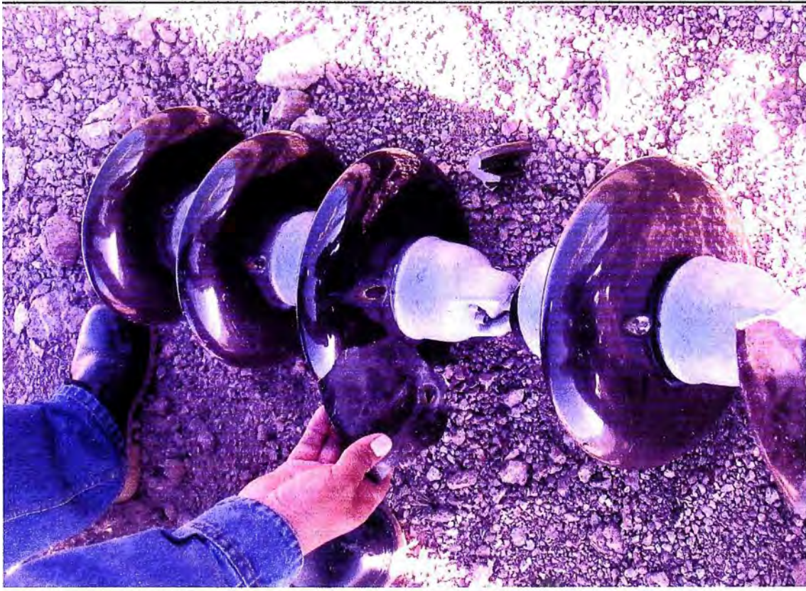
Foto 08: SER Coracora, línea de fuga de descarga en aisladores de LT
