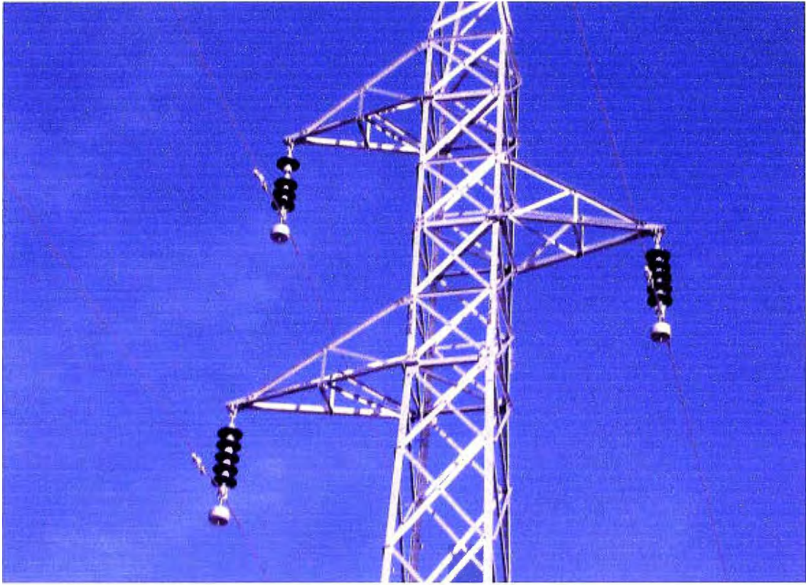
Foto 07: SER Coracora, estragos de descargas atmosféricas en línea de transmisión
