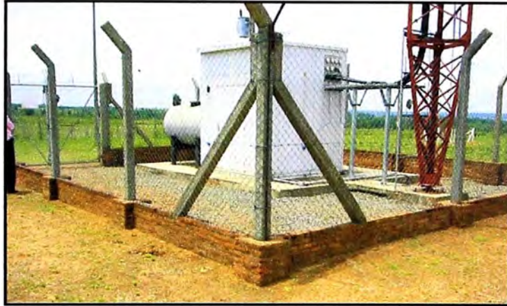
Figura 1.3 Sala para equipos (Fuente: Empresa Telefónica Móviles)
