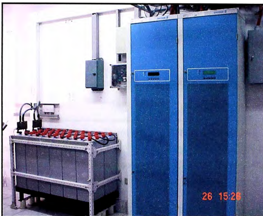
Figura 1.6 Rectificador Ibérica y Banco de baterías (Fuente: Ibídem)
