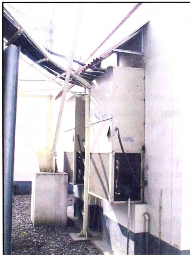
Figura 1.4 Equipos de Aire Acondicionado tipo Mochila (Fuente: Ibidem)
