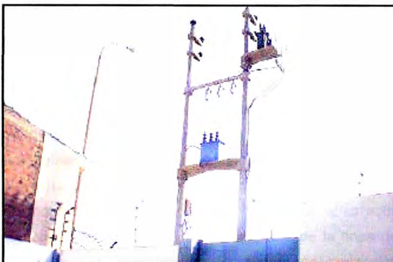
Figura 1.5 Entrada de energía AC Transformador y transformix (Fuente: Ibídem)
