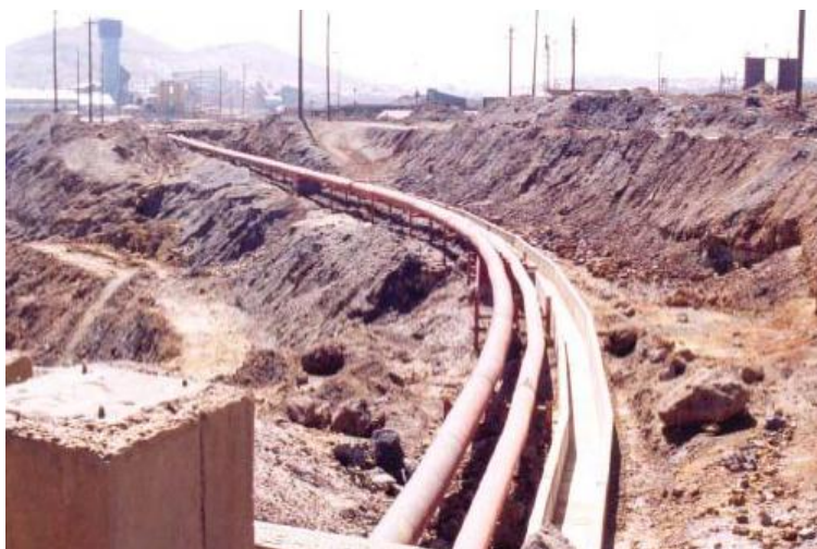
Figura 7.3 Tubería de 12" dirigida hacia la poza de relave
