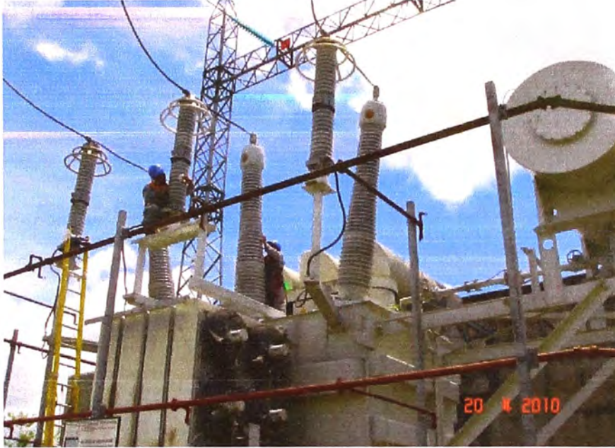
Figura 2.2 – GSUT Transformador Elevador de 100 MVA, CCTT Aguaytia
