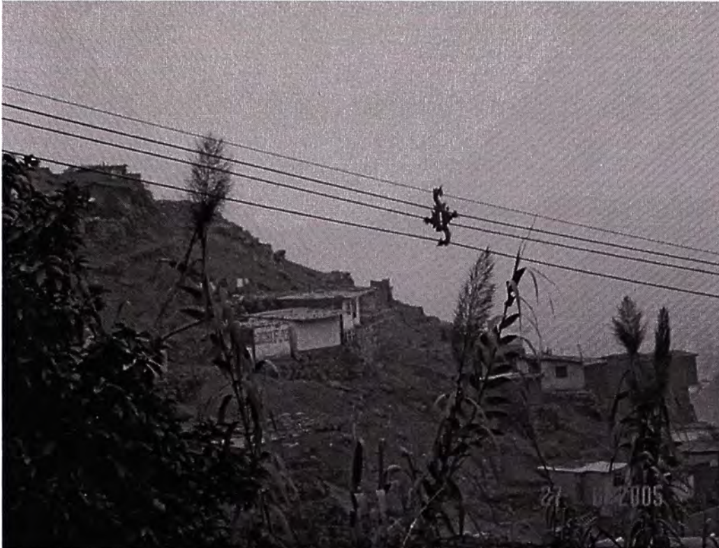
Foto 9.- Espaciador de cable cruzando una zona arbolada.
