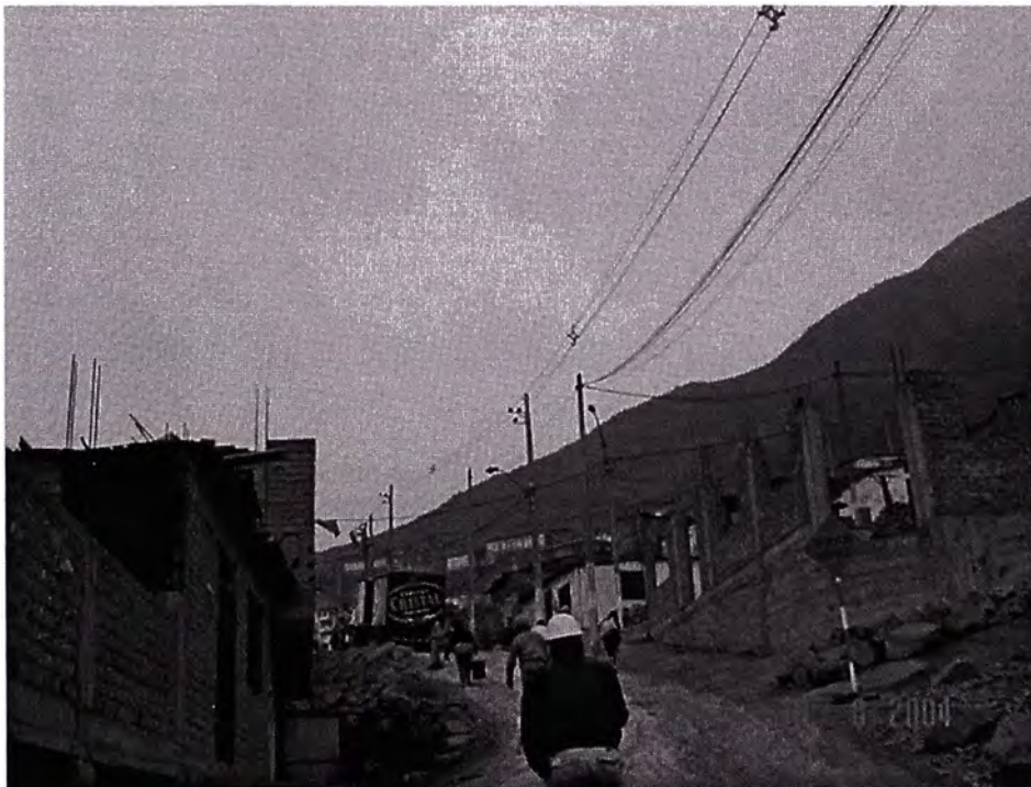
Foto 10.- Red aérea compacta instalada en calle estrecha.
