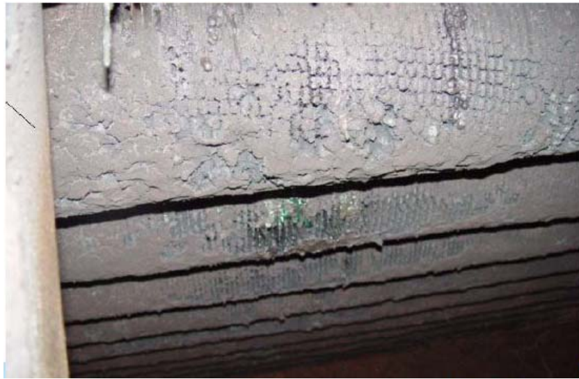
Figura 2.13: Nivel de Ensuciamiento Tubos aletados segmentados
