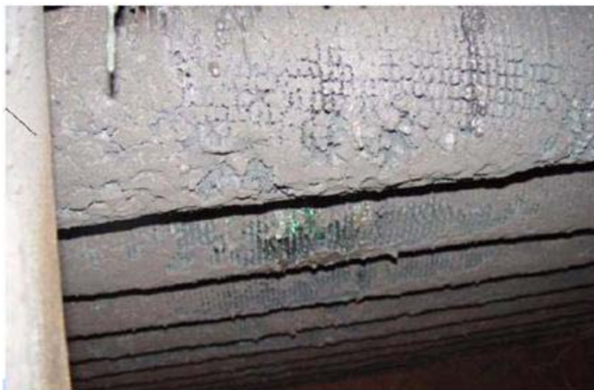
Figura N° 4.1: Ensuciamiento de Zona Convectiva
