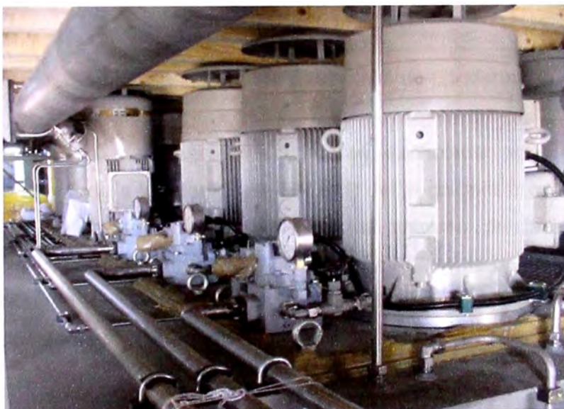
Fig. 3.3 Motores de bombas de aceite lubricante e hidráulico.
