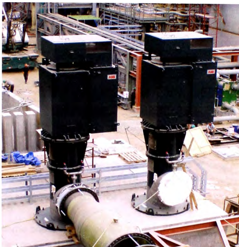
Fig. 3.5 Bombas de agua de refrigeración Principal
