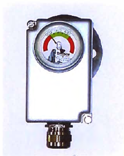
Fig. 3.13 Sistema de monitoreo de gas SF6
