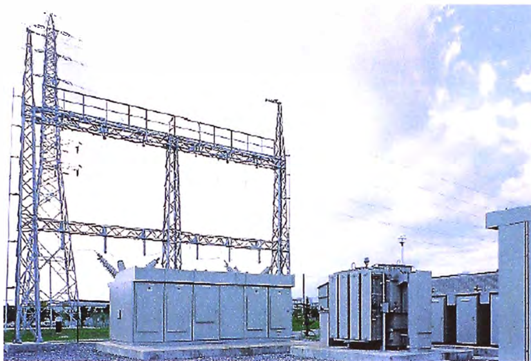
Fig. 3.15 Instalación a la Intemperie
