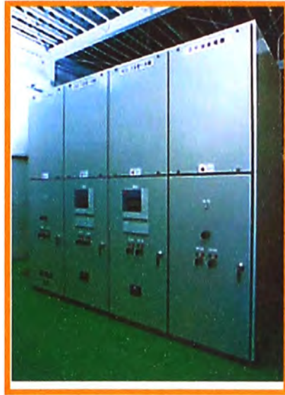
Fig. 3.38 Celdas con aislamiento sólido
