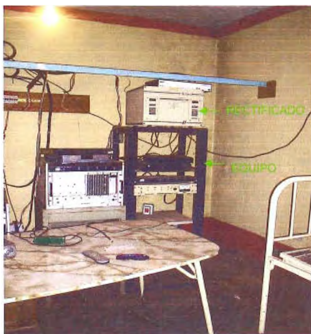
Fig. 3.4 Sala de equipos
