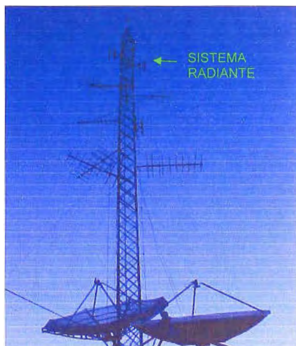
Fig.3.5 Torre con sistema radiante
