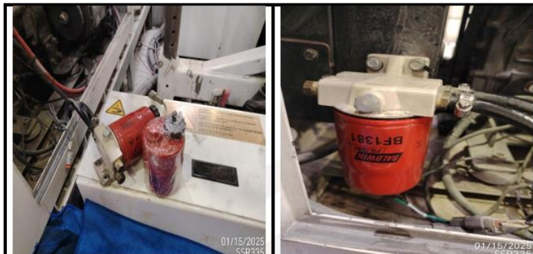
Imagen 10 & 11: Filtro Secundario Combustible antes y después
