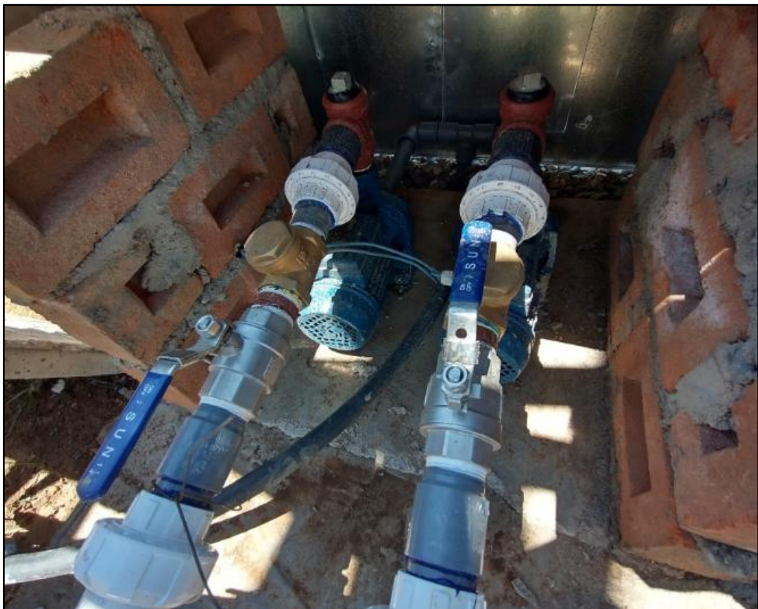
Sistema de bombeo de agua
