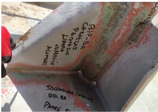
Parte inferior cartelas BIP-BR sobrecubierta con ligera corrosión aceptado.
