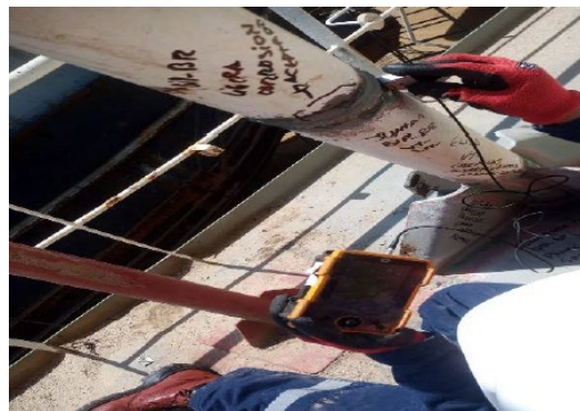
Junta 1 de BIP-BR inspección por ultrasonido industrial aceptada.
